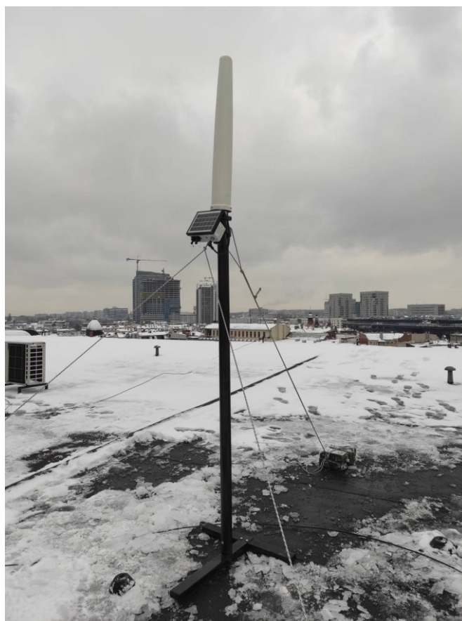
Rys. 2 Miejsce montażu SMS PEM – UM w Katowicach
