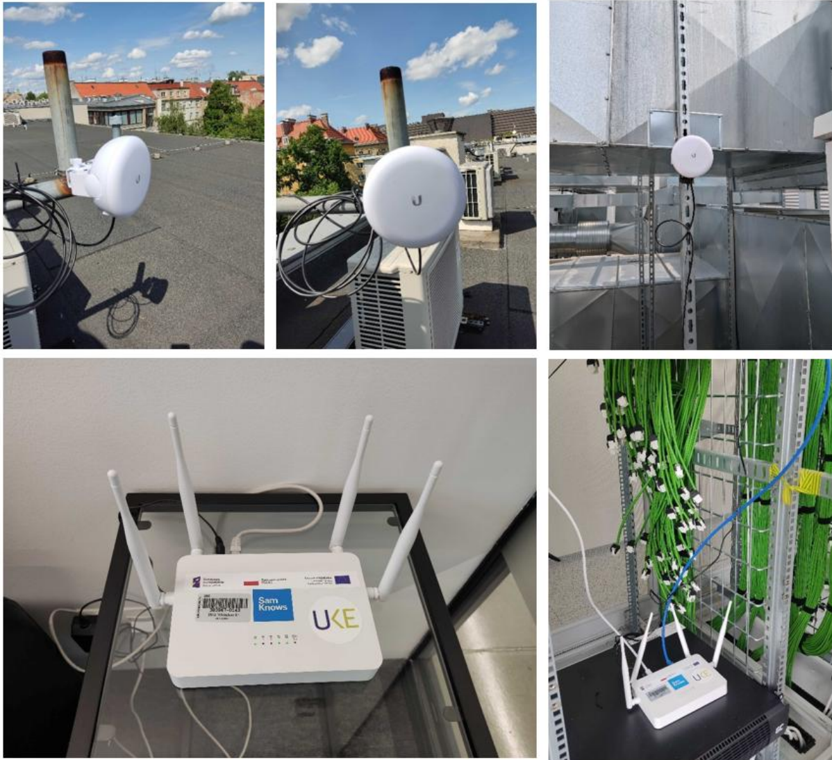
Rysunek 3. Widok na przykładowe instalacje anten i urządzeń Whitebox 8+ zainstalowanych u użytkowników końcowych
