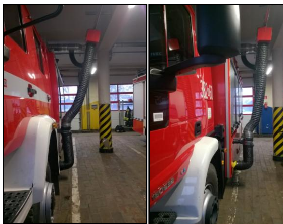
Fot. Odciągi spalin w JRG nr 2.
