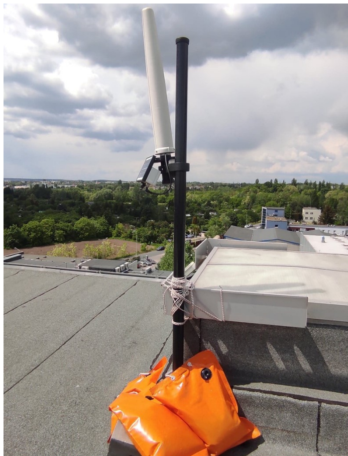
Rys. 2 Miejsce montażu SMS PEM – WCWJ w Poznaniu
