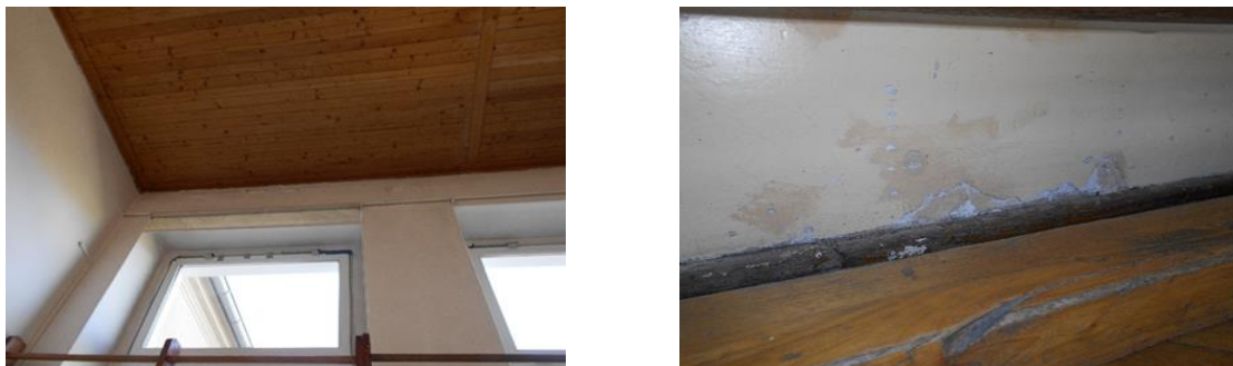
Rys. 24 Niewłaściwy stan sanitarno-higieniczno-techniczny parkietu w sali rekreacyjno-zastępczej
