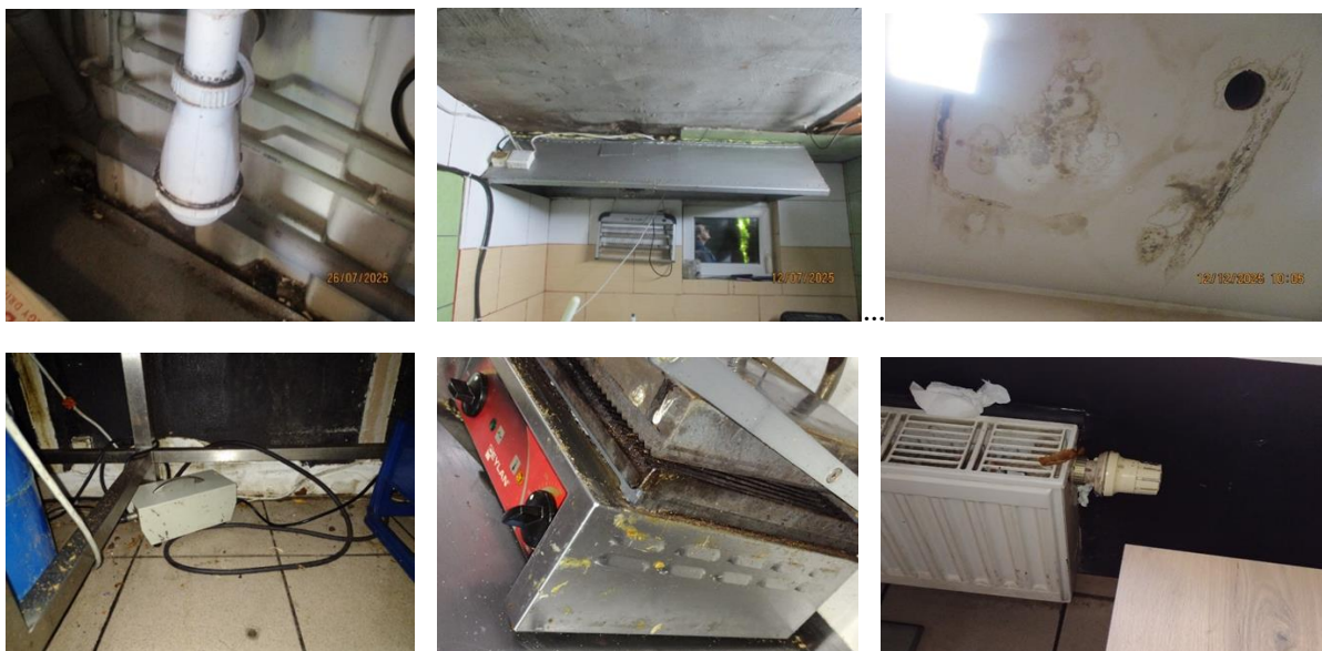
Rys. 41 Przykłady nieprawidłowości stwierdzanych podczas kontroli sanitarnych
