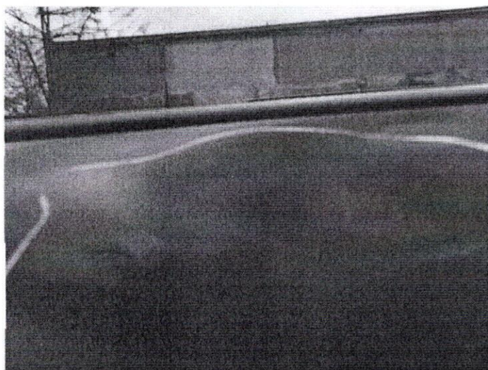
Fot. 11 Uszkodzenie dachu - prawa strona, tył
