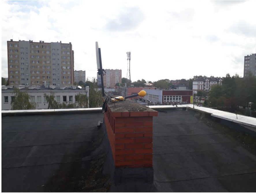
Rys. 3 Miejsce montażu SMS PEM – ZSO nr 1 w Mielcu – widok na SBTK
