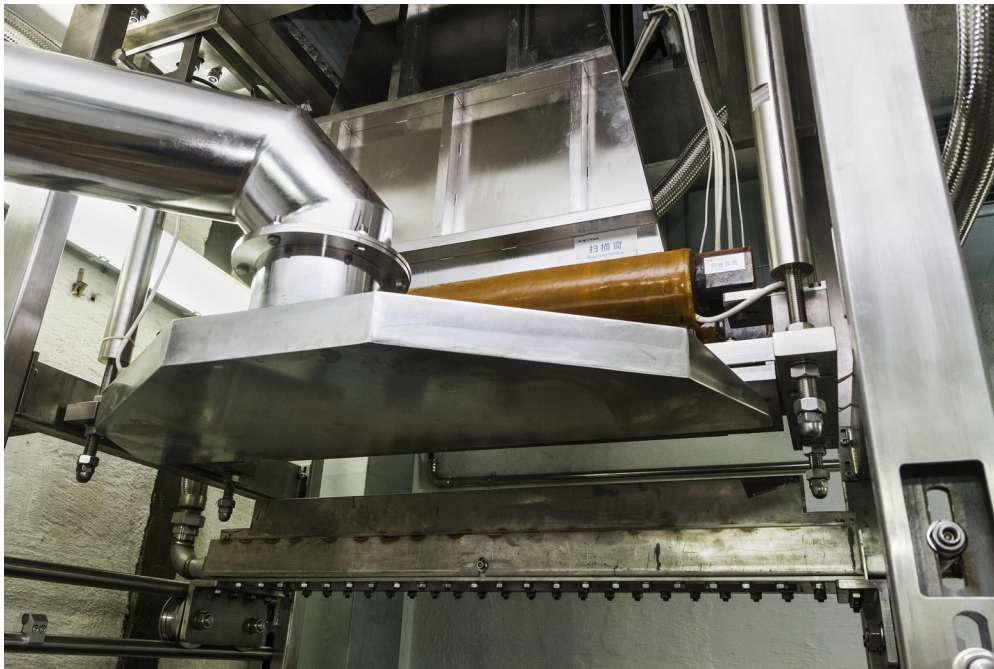
Fot. 2. Instalacja do konwersji wiązki elektronów na promieniowanie hamowania nowego akceleratora w Stacji Sterylizacji Radiacyjnej Wyrobów Medycznych i Przeszczepów w IChTJ (źródło: IChTJ).
