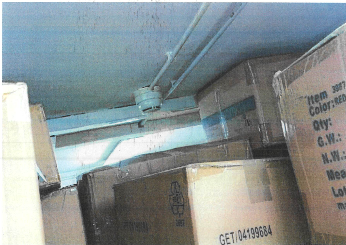
Fot. nr 2 – Zastawiona czujka ppoż. w pomieszczeniu nr 019 (piwnica)
