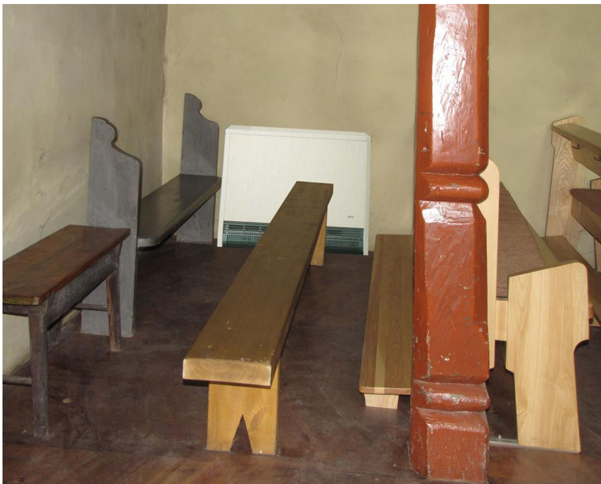
Fot.10 Zainstalowane w nim inteligentne ogrzewanie akumulacyjne zaprojektowano i wykonano z dużą starannością i troską o stworzenie bezpiecznych warunków dla cennego wyposażenia. Po czterech sezonach grzewczych widoczna jest lekka depozycja kurzu na ścianach, jednak zdecydowanie mniejsza niż przy ogrzewaniu wysokotemperaturowym. Fot. ks. W. Dokurno
