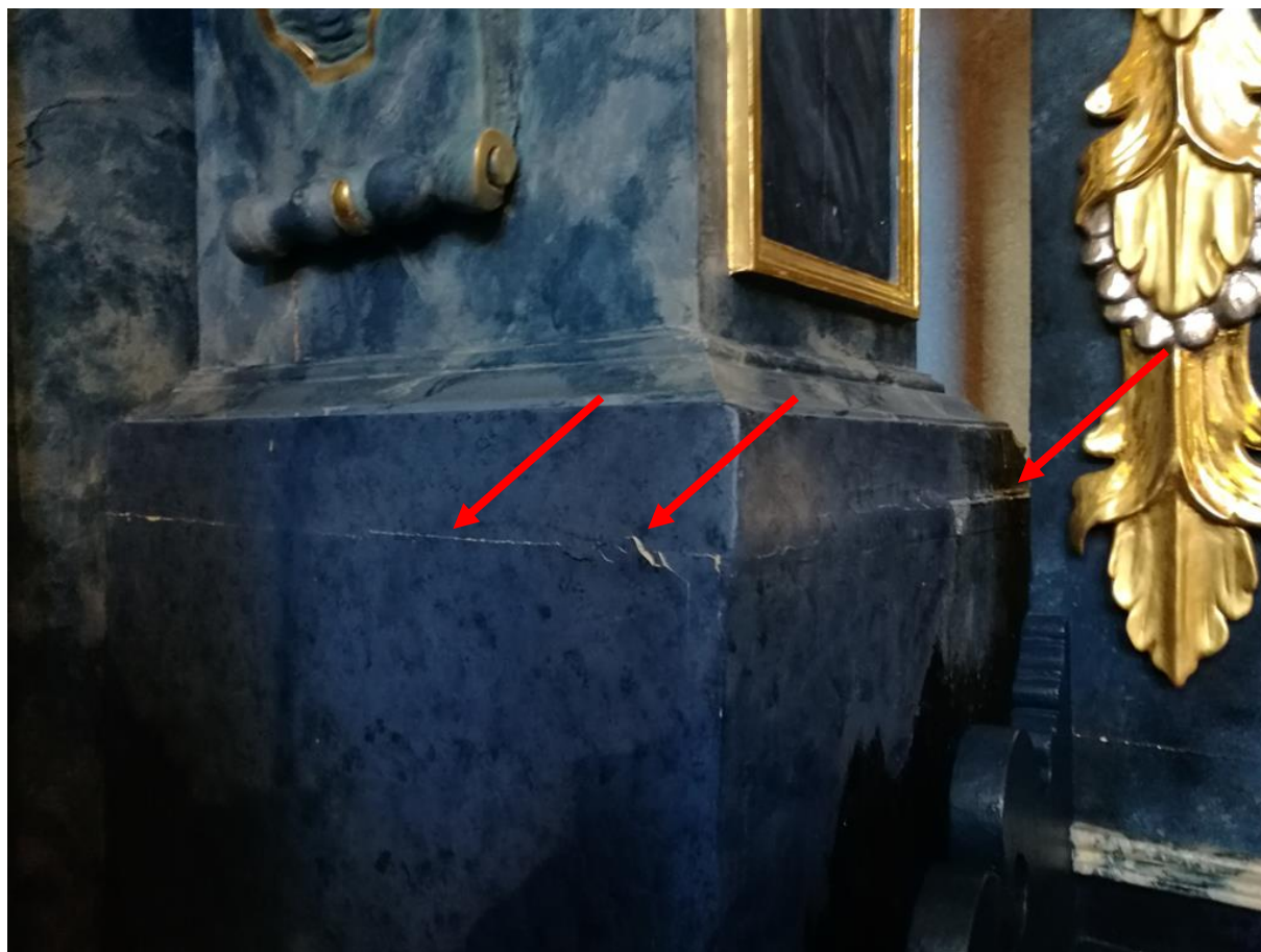
Fot. 8 Złącza ciesielskie konstrukcji ołtarza uległy rozchwianiu, powstały liczne bardzo głębokie pęknięcia drewna a spękana i spęcherzona polichromia w wielu miejscach grozi odpadnięciem. Fot. B. J. Rouba
