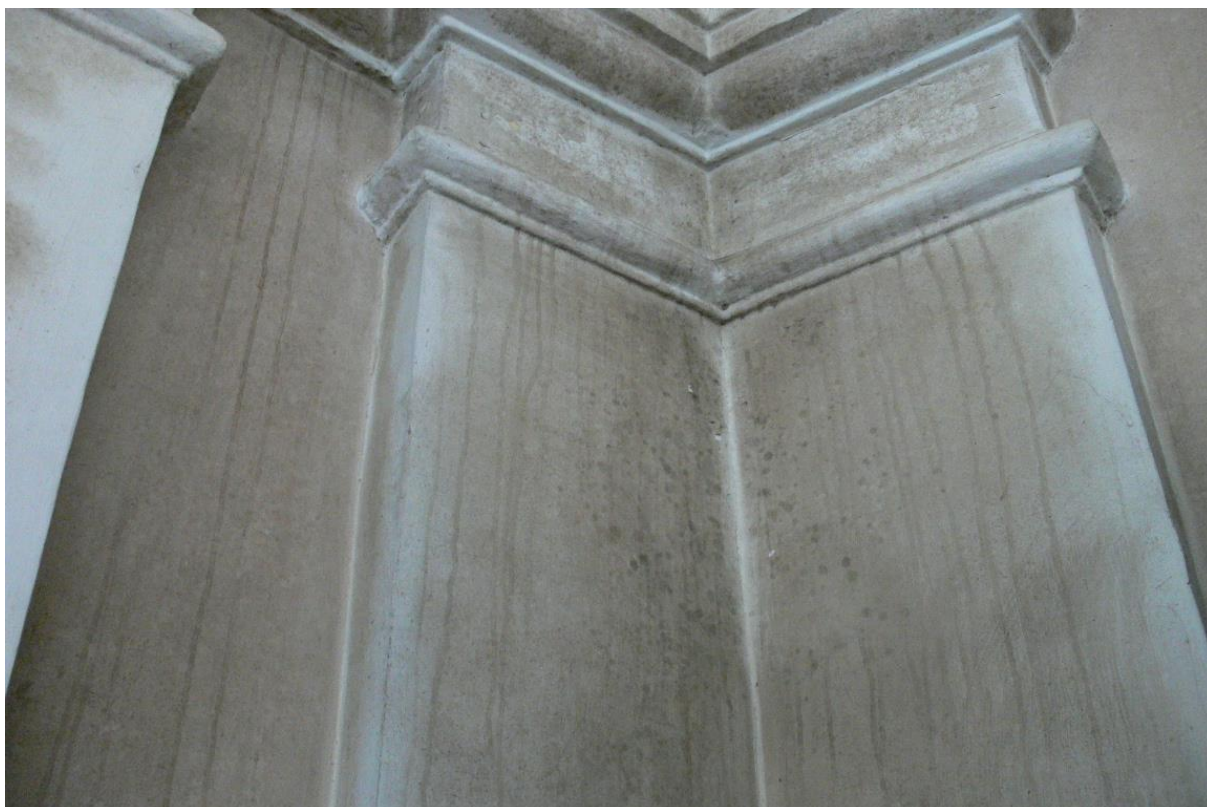
Fot. 4. Niewielki gotycki kościół kamienny. Na fotografii widok ściany kaplicy bocznej dobudowanej do bryły kościoła w 1600 r. (cegła, tynk wapienno-piaskowy, warstwy wymalowań). Przypadek obiektu ekstremalnie zawilgoconego i zagrzybionego za sprawą ogrzewania nadmuchowego i źle rozwiązanej wentylacji. Strugi wody ciekącej po ścianach powstają jako wynik niemal każdego włączenie pieca. Fot. B. J. Rouba
