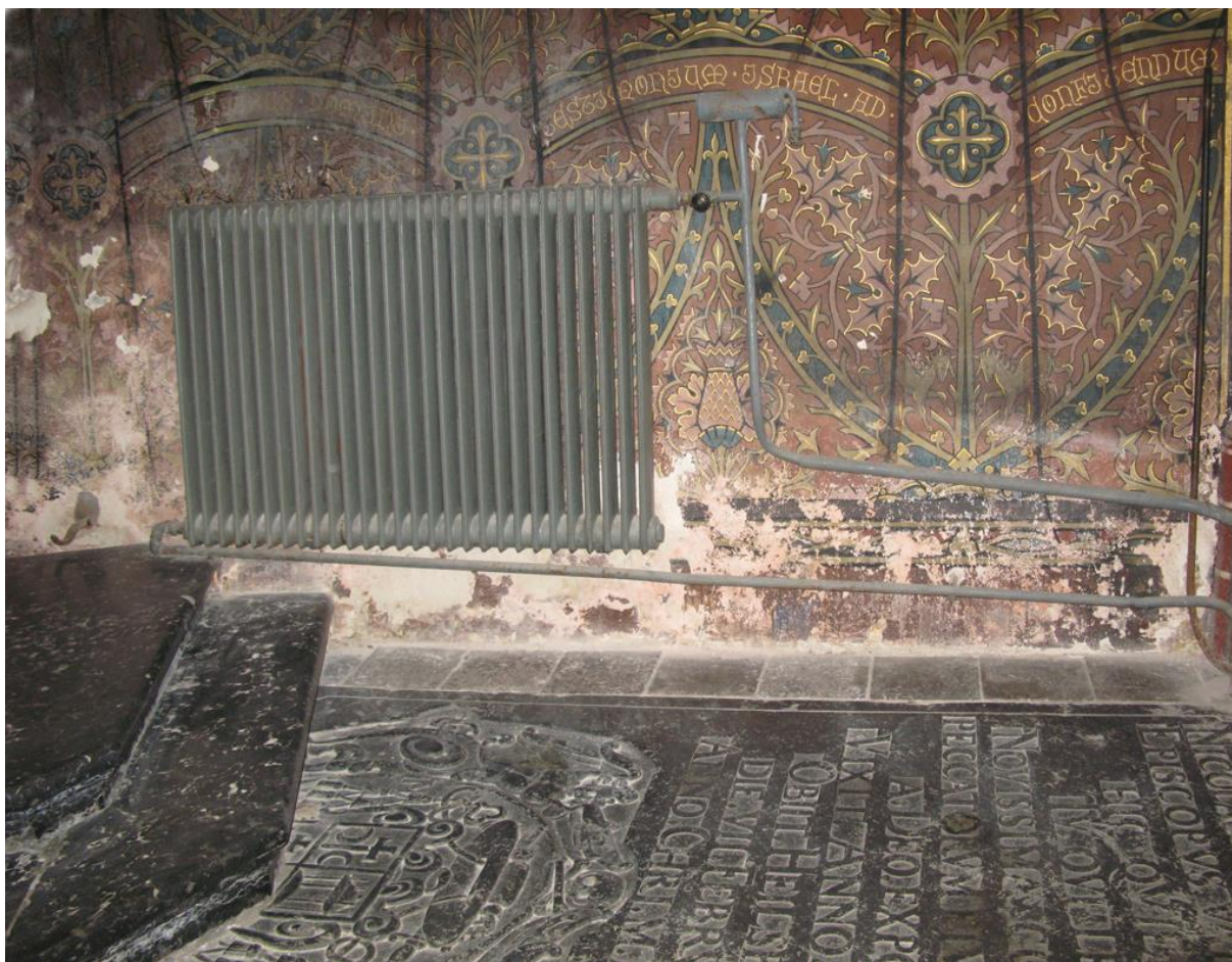
Fot. 2. Nie należy instalować ogrzewania w kościołach z nierozwiązanymi problemami zawilgocenia... W tym przypadku ogrzewanie mokrej ściany przyspiesza procesy migracji soli do powierzchni i niszczenia malowideł. Fot. B. J. Rouba
