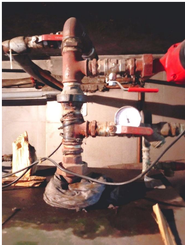
Fot. 2 Istniejący kocioł na paliwo stałe - armatura
