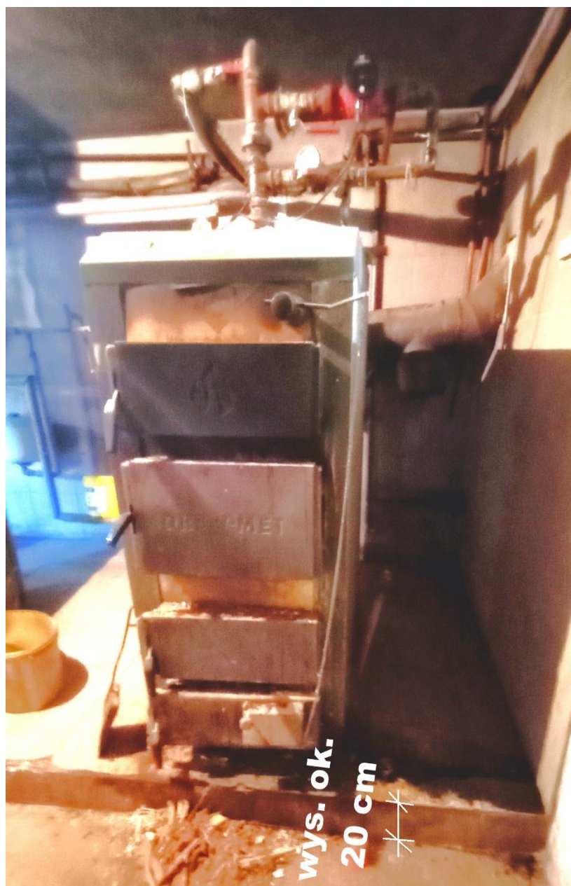
Fot. 3 Istniejący kocioł na paliwo stałe (wysokość podestu betonowego ok. 20 cm)
