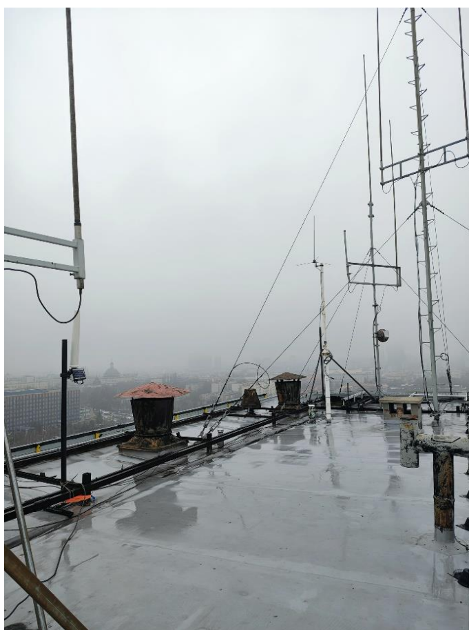
Rys. 4 Widok na stację retransmisyjną z miejsca montażu SMS PEM – Urząd Miasta Katowice
