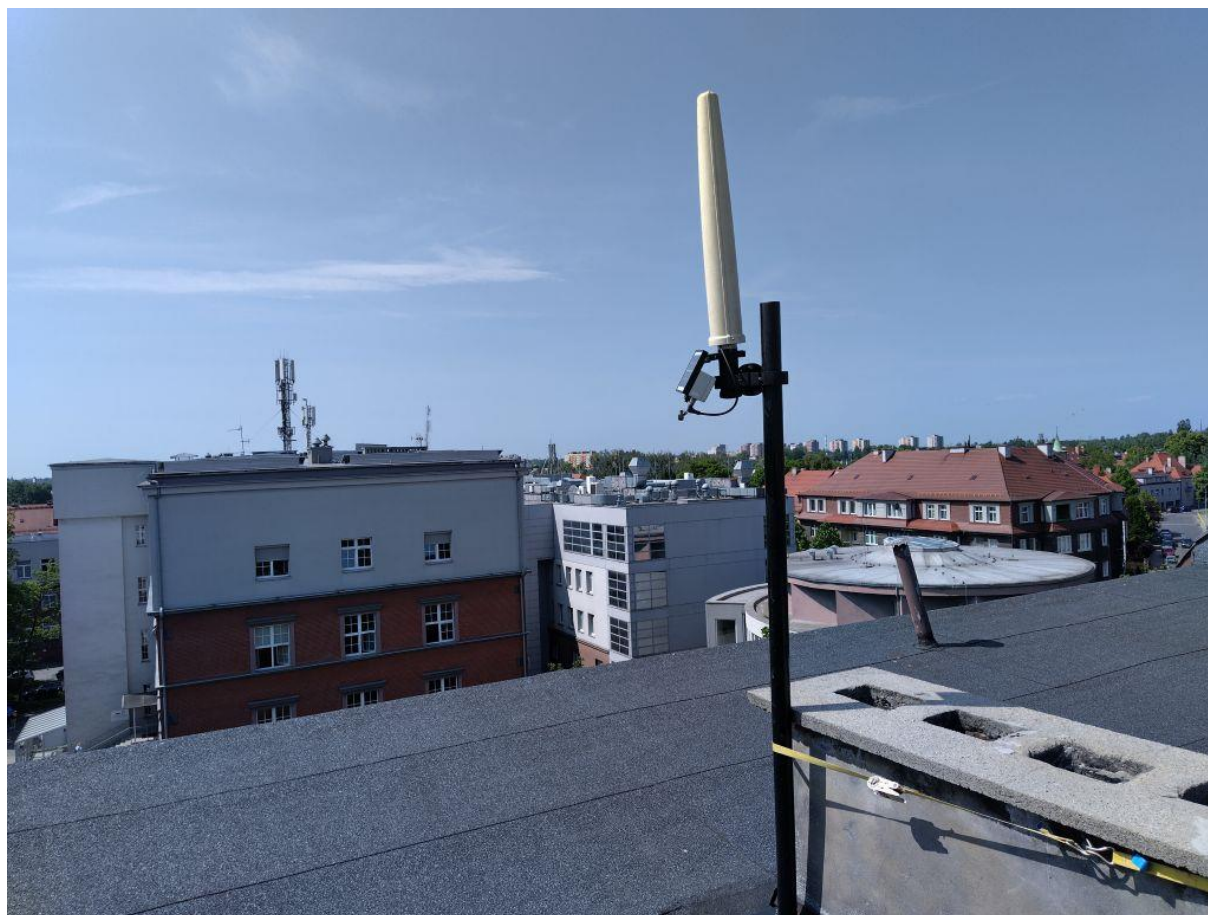
Rys. 3 Miejsce montażu SMS PEM – Budynek, ul. Batorego 34 – widok na SBTk
