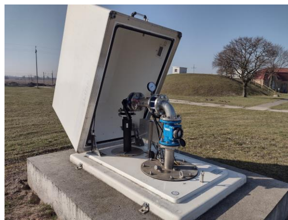
Zdjęcie 2. Studnia naziemna na Stacji Uzdatniania Wody w Środzie Wielkopolskiej
