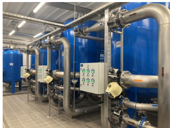
Zdjęcie 4. Pomieszczenie hydroforni na Stacji Uzdatniania Wody w Zaniemyślu
