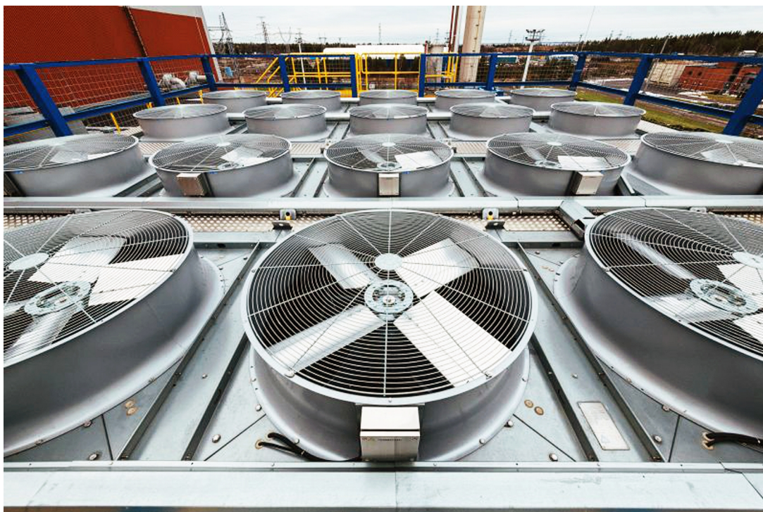
Rys. 8. Chłodnia wentylatorowa na budynku agregatów prądotwórczych obsługujących dwa starsze bloki 1 i 2 Elektrowni Jądrowej Olkiluoto w Finlandii (Fot. TVO).
