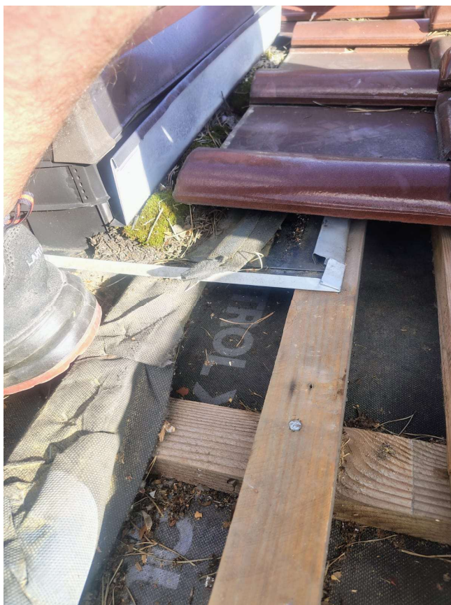
Fot. 9. Niedrożny system odprowadzenia wód opadowych przy oknach dachowych
