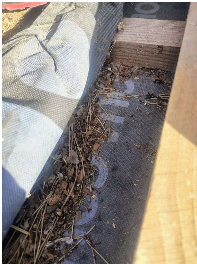
Fot. 7. Odpady z roślinności znajdujące się przy obróbkach okien dachowych
