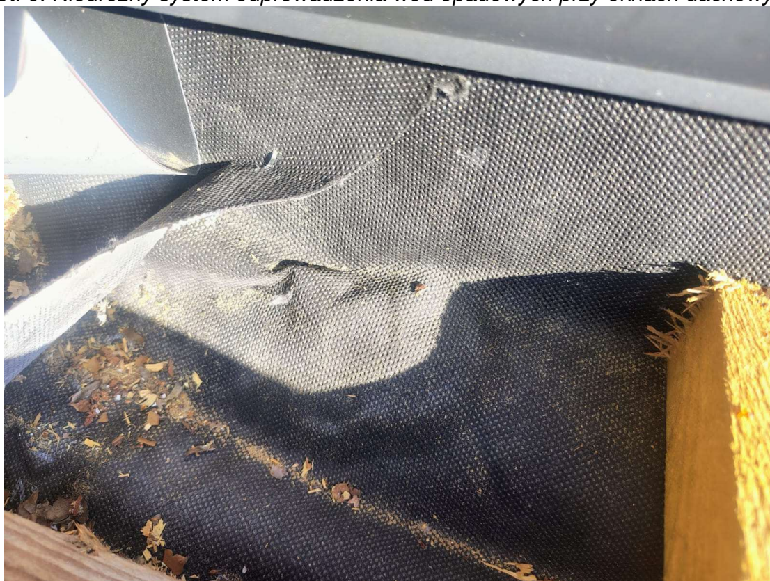
Fot. 10. Nieprawidłowy montaż folii wstępnego krycia
