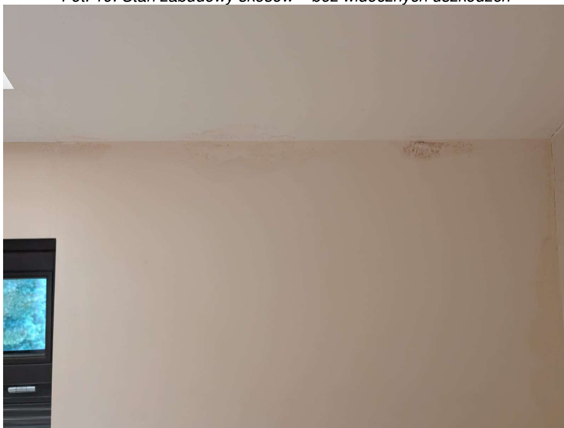
Fot. 20. Widoczne uszkodzenia zgłoszone przez Zarządcę obiektu
