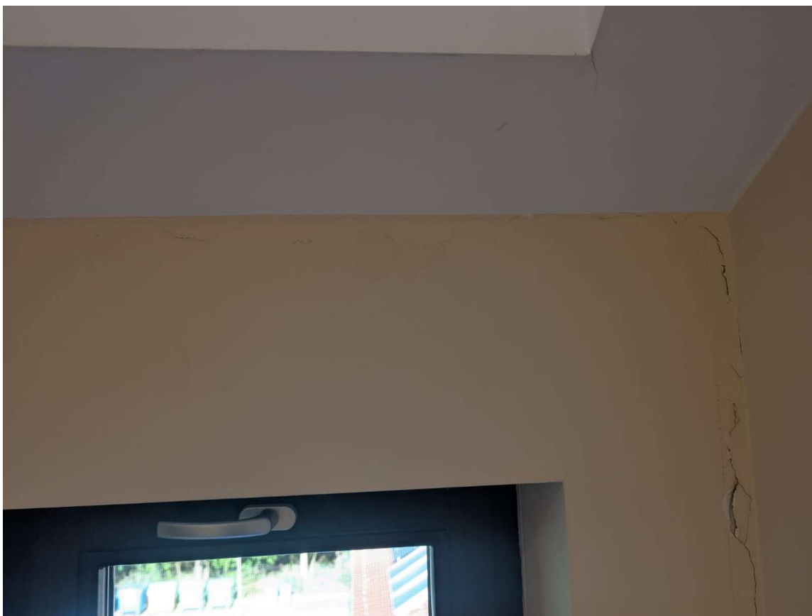
Fot. 21. Widoczne uszkodzenia zgłoszone przez Zarządcę obiektu
