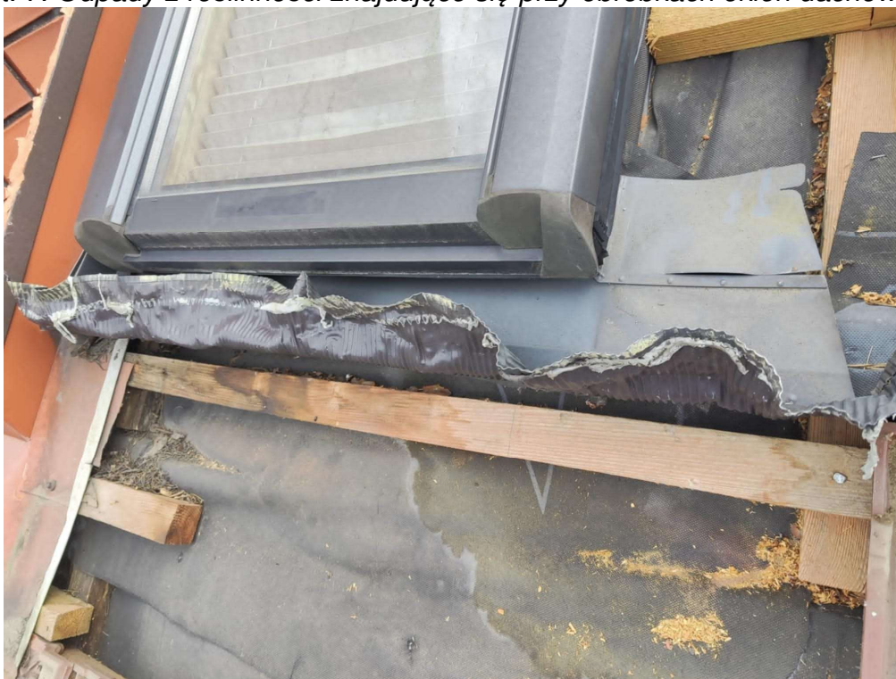
Fot. 8. Niedrożna obróbka okna dachowego – nieprawidłowe odprowadzenie wód powoduje przedostanie się wody na folię wstępnego krycia
