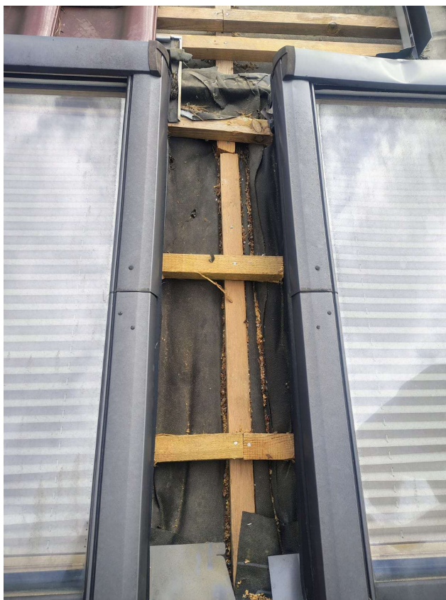
Fot. 3. Widoczne zastoiska wody oraz brak ciągłości foli wstępnego krycia w rejonie okien dachowych
