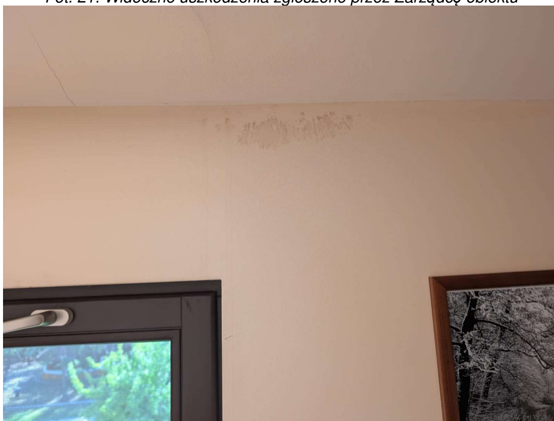
Fot. 22. Widoczne uszkodzenia zgłoszone przez Zarządcę obiektu
