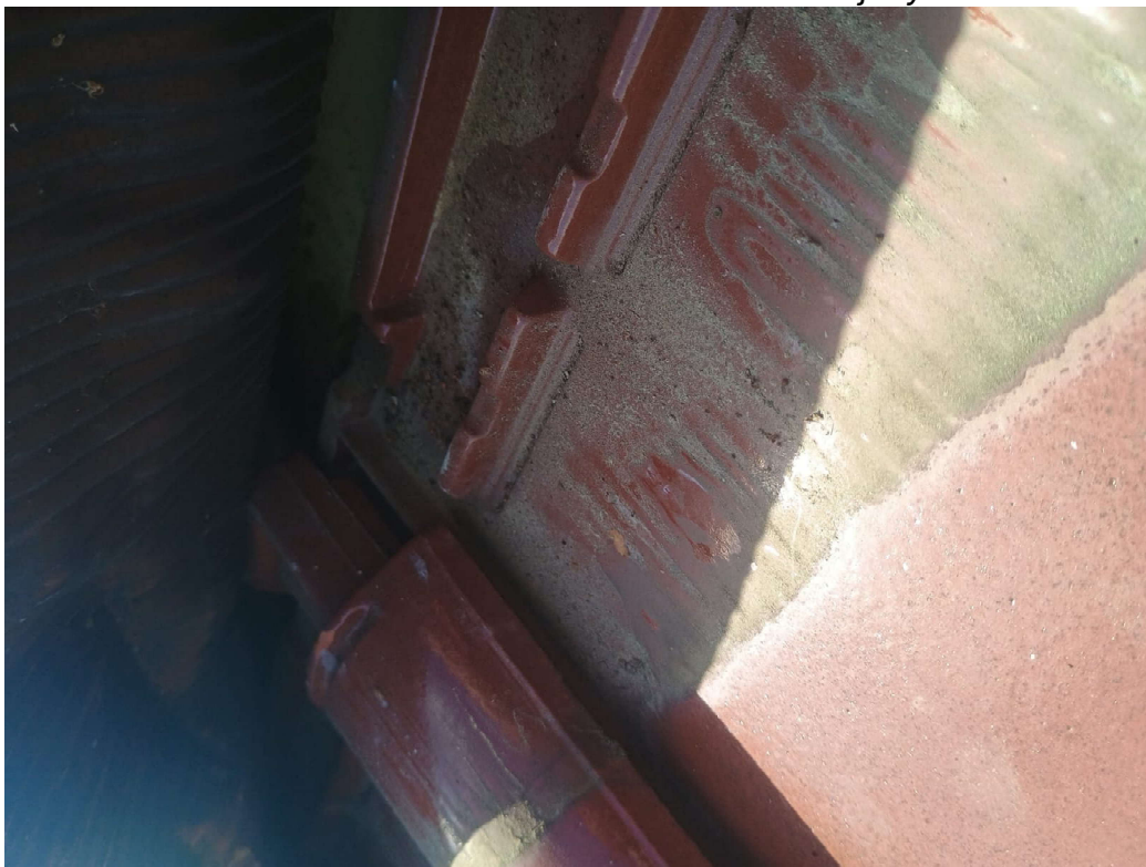
Fot. 2. Nieszczelność obróbek przy oknach dachowych.
