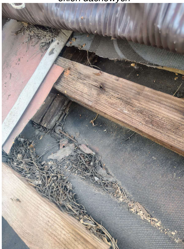
Fot. 4. Widoczne zastoiska wody na foli wstępnego krycia
