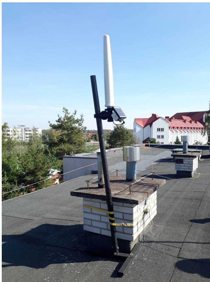
Rys. 3 Miejsce montażu SMS PEM – DPS w Suwałkach
