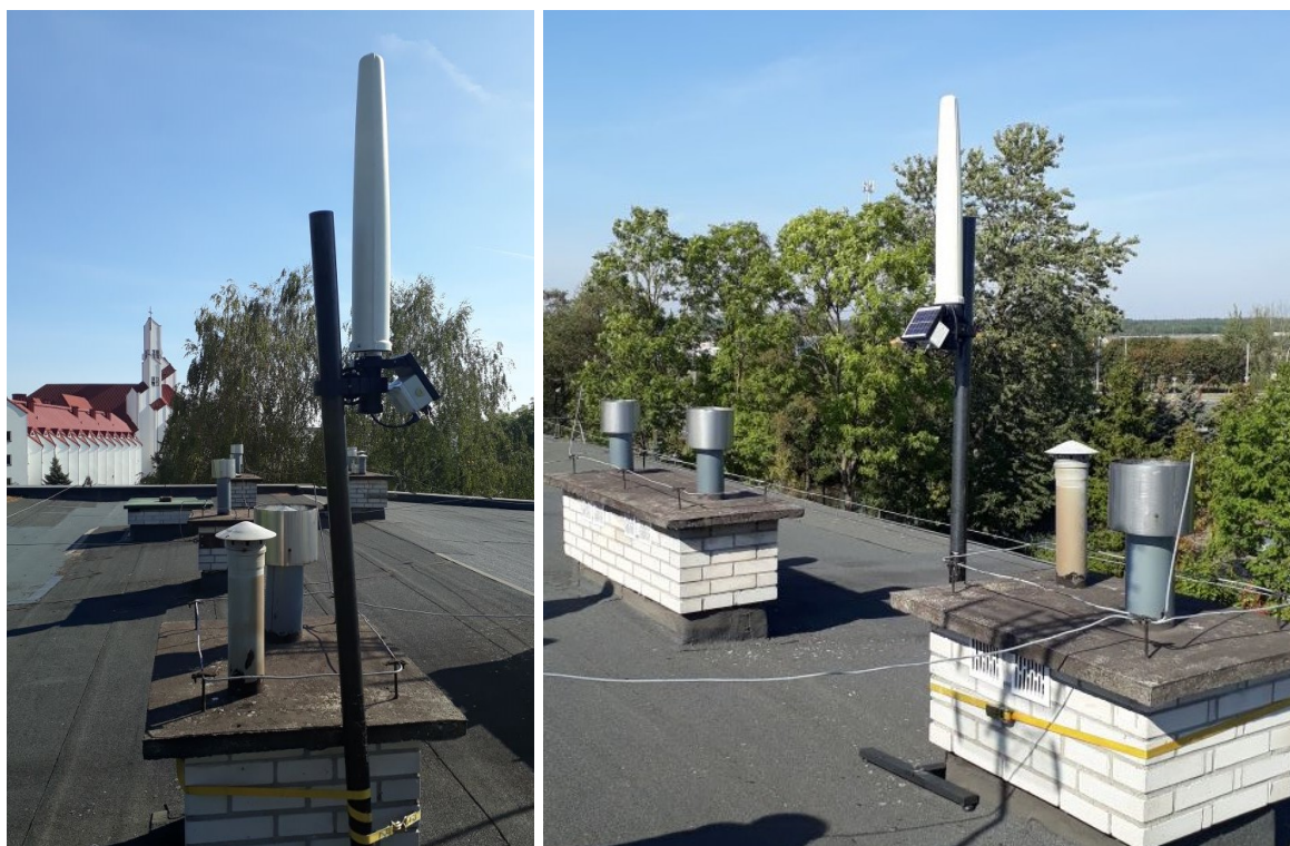
Rys. 4 Miejsce montażu SMS PEM – DPS w Suwałkach – widok na SBTk
