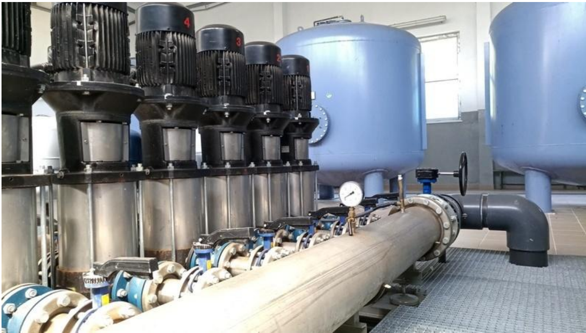
Fot. 5. Elementy instalacji w stacji uzdatniania wody w Turzy.
