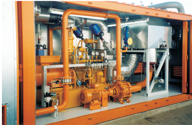
Rys. 3.3.5. Część główna elektrowni geotermalnej w Neustadt Glewe, moc N_{el} = 210 kW (foto: A. Stachel)
