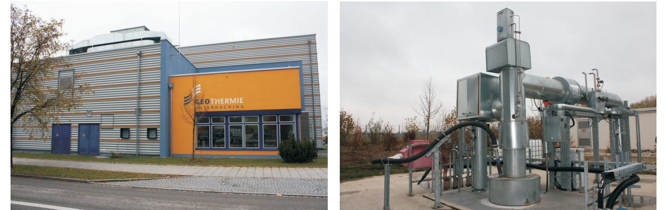
Rys. 3.3.6. Widok na elektrownię geotermalną w Unterhaching oraz ujęcie eksploatacyjne (foto: B. Tomaszewska 2013)
