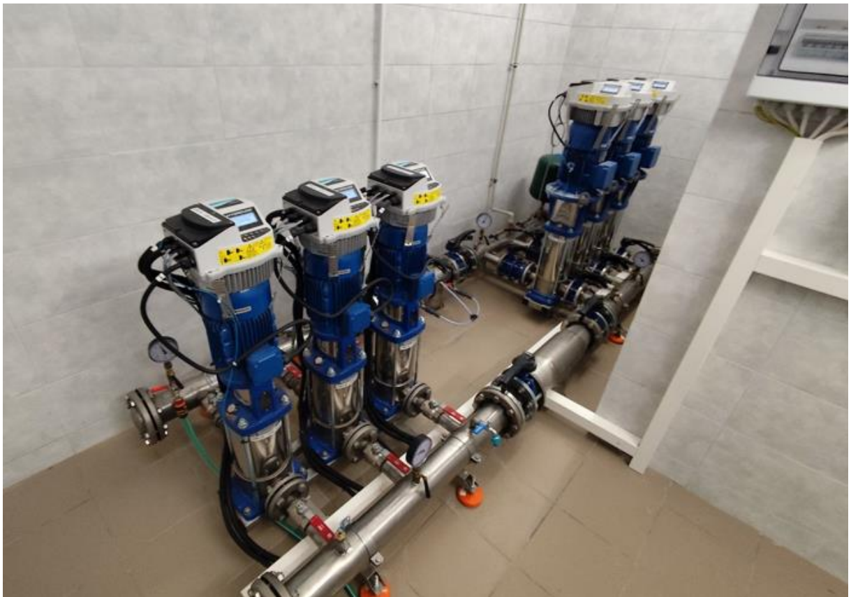
Fot. Stacja Uzdatniania Wody – pompy w budynku stacji
