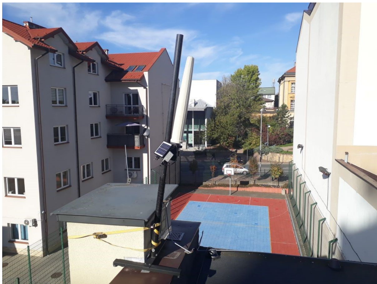
Rys. 5 Miejsce montażu SMS PEM – 3 LO w Tarnowie – widok na SBTK
