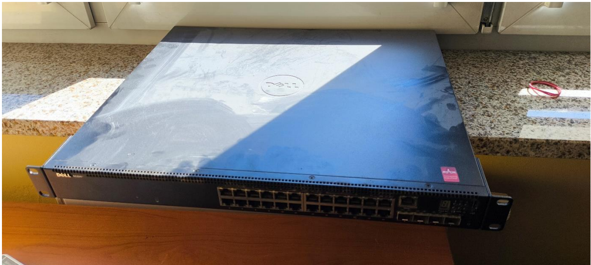
15. Przełącznik switch ethernet typu rack
