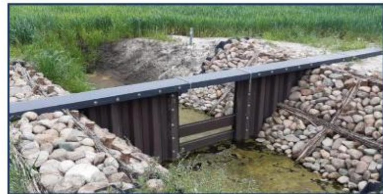
Rycina 7 Zainstalowane szamochy w obiektach melioracyjnych (strawów nad Pilicą (wój. mazowiecki)). Projekt INOMEL, autorzy projektu urządzenia: E. Kaca, R. Oleszczuk (WBiŚ SGGW), Fot. D. Kierosiński
