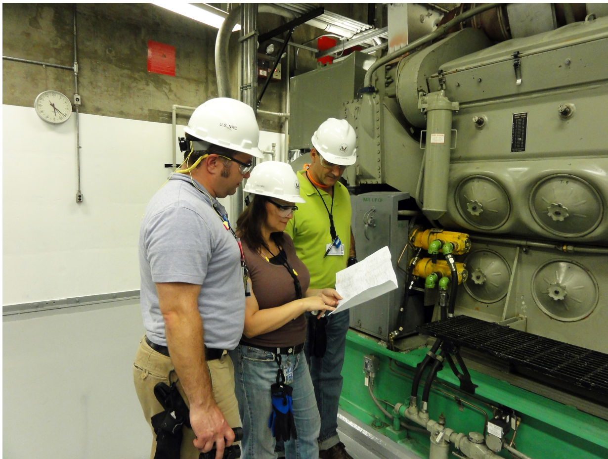
Fot. 5. Inspektorzy NRC (od lewej do prawej): Robert Krsek, Annie Kammerer i Steve Campbell dokonują przeglądu zapasowych agregatów prądotwórczych w elektrowni jądrowej Kewaunee w Wisconsin (fot. U.S. NRC).
