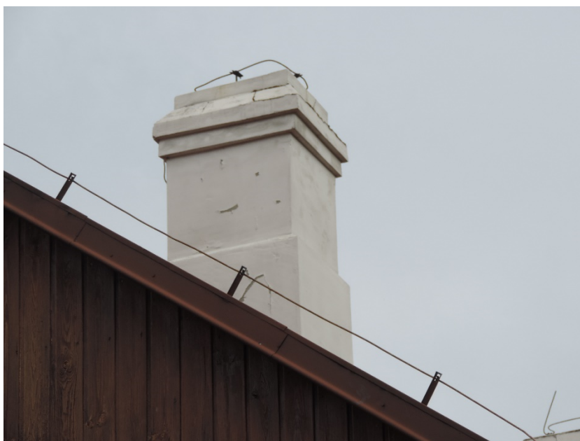
Foto Nr 6. – Stan komina Nr 2
