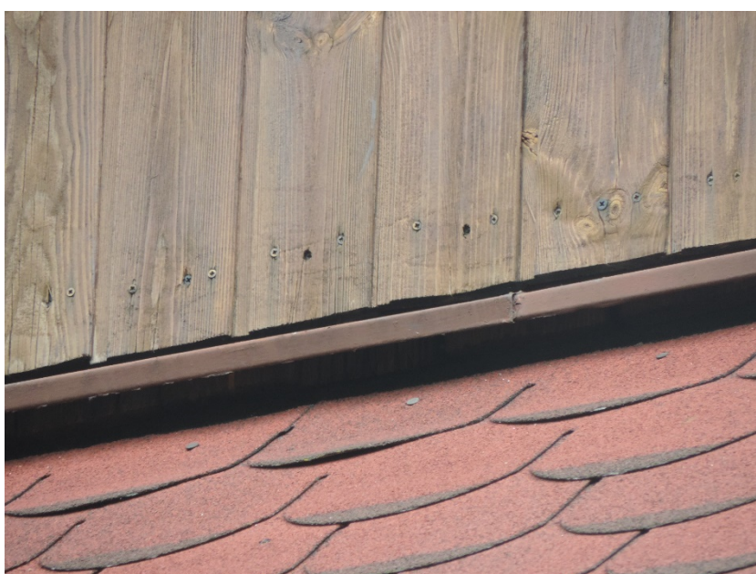
Foto Nr 18. – Stan obróbek blacharskich ściany szczytowej
