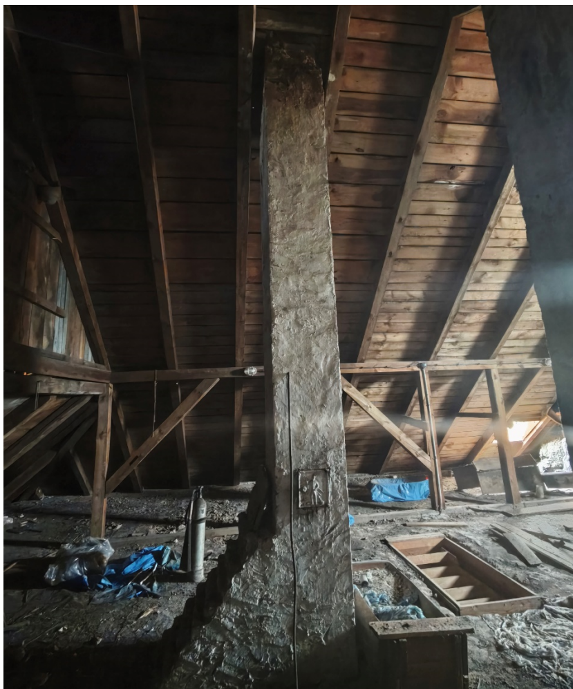
Foto Nr 9. – Stan komina Nr 1
