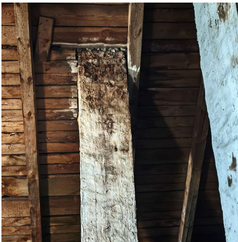
Foto Nr 8. – Stan komina Nr 2
