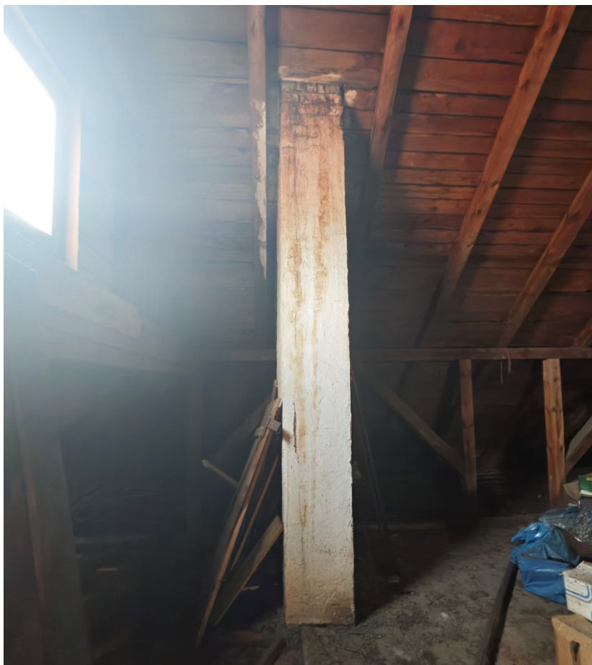
Foto Nr 7. – Stan komina Nr 3 poniżej połaci
