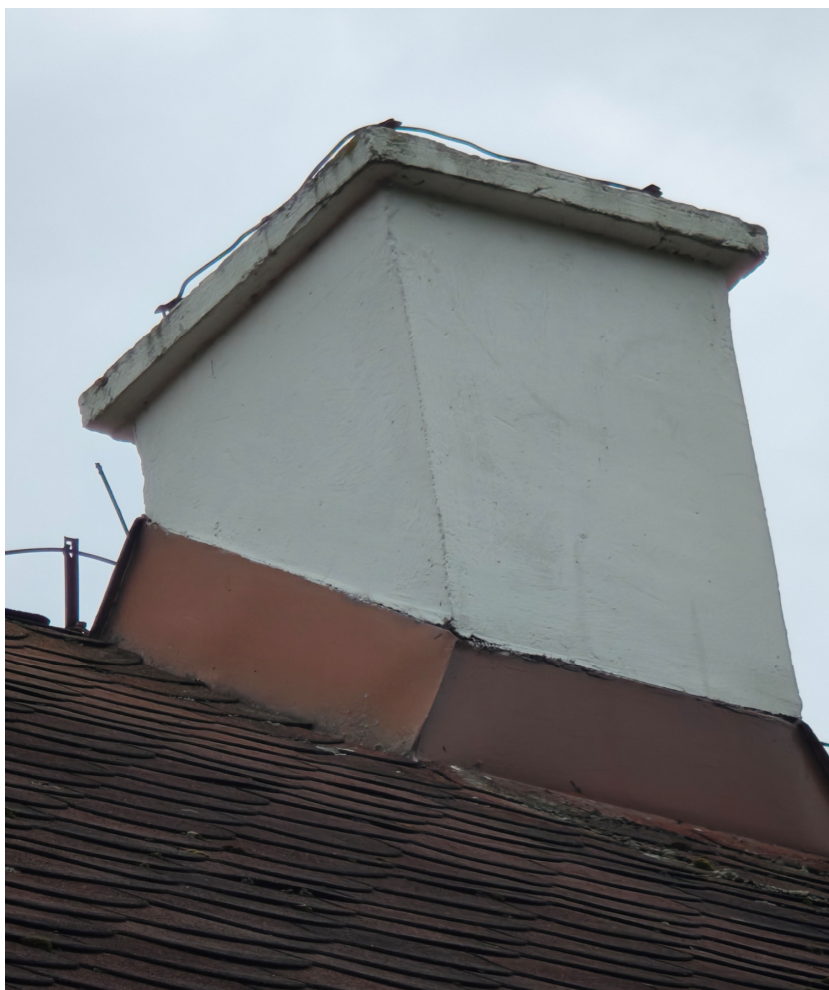
Foto Nr 5. – Stan komina Nr 1
