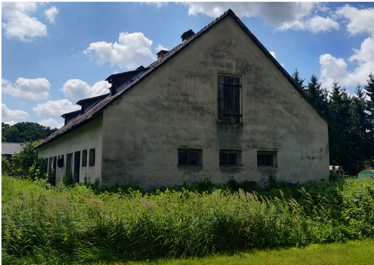
Fot. 4. – Widok szczytu budynku od strony północnej; zawilgocenia ścian i porażenia biologiczne, uszkodzenia tynków elewacji, uszkodzenia stolarki i ślusarki otworowej
