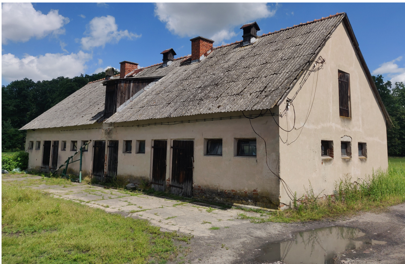
Fot. 2. – Widok budynku od strony południowo-zachodniej: zawilgocenia ścian, uszkodzenia i odspojenia tynków elewacji zwłaszcza w przyziemiu, zarysowania murów, uszkodzenia i nieszczelności pokrycia dachu, uszkodzenia stolarki i ślusarki otworowej, uszkodzona szczątkowa instalacja elektryczna
