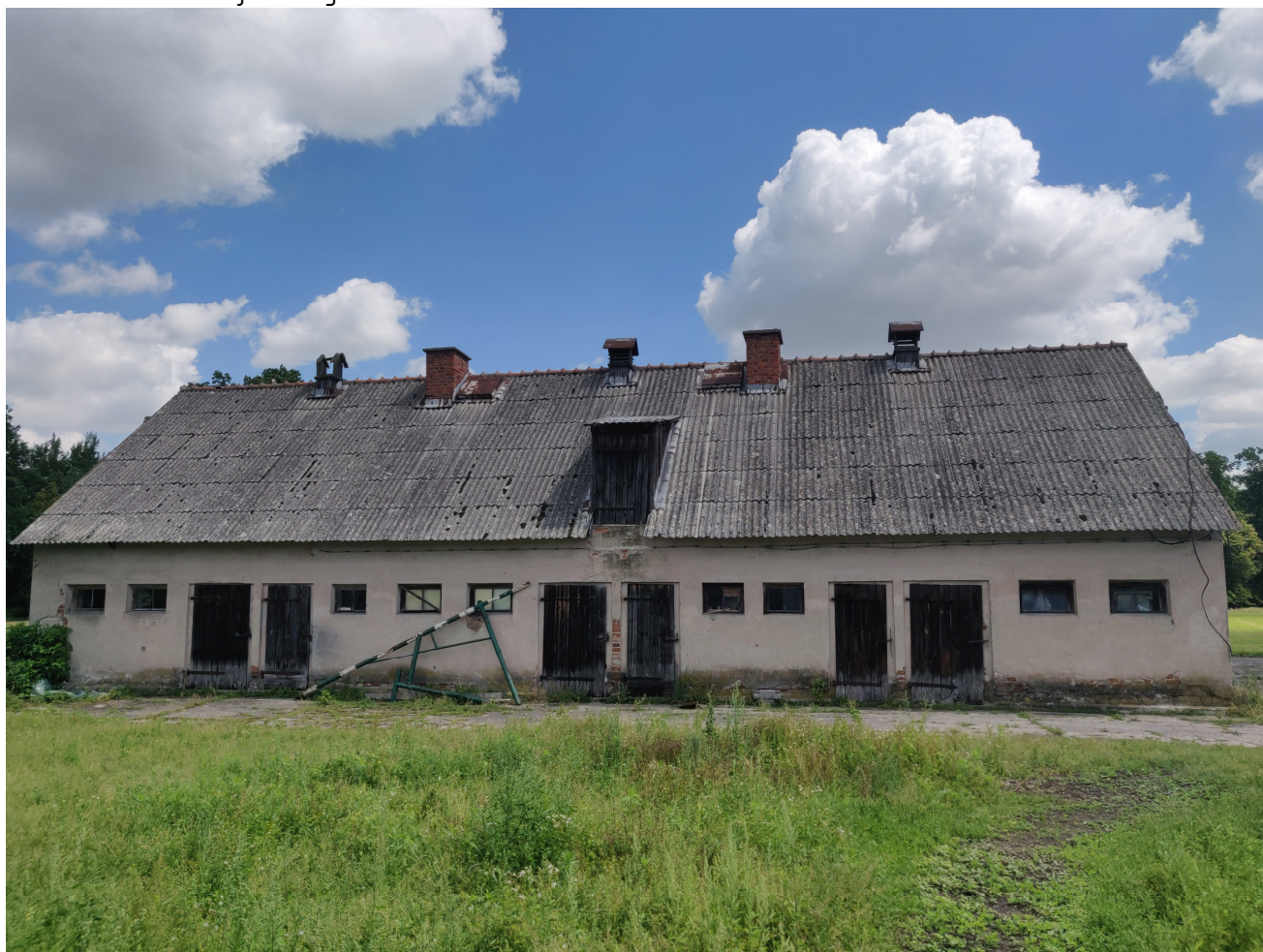
Fot. 1. – Widok budynku od strony zachodniej: zawilgocenia ścian, uszkodzone i odspojone tynki elewacji w przyziemiu, nieszczelności pokrycia dachu i uszkodzenia kominów, uszkodzenia stolarki i ślusarki otworowej
