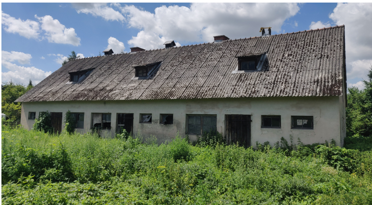
Fot. 3. – Widok budynku od strony wschodniej: zawilgocenia ścian, uszkodzenia i odspojenia tynków elewacji, nieszczelności pokrycia dachu i uszkodzenia kominów, uszkodzenia stolarki i ślusarki otworowej
