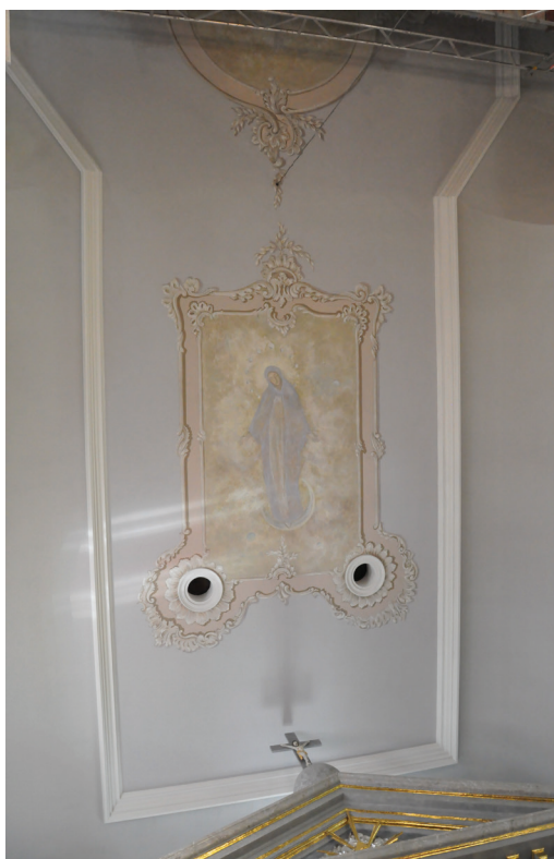
8. Juchnowiec. Malowidło na suficie w prezbiterium, stan po konserwacji. Fot. Krzysztof Stawicki Juchnowiec. Ceiling painting in the presbytery, condition after conservation. Photo by Krzysztof Stawicki
