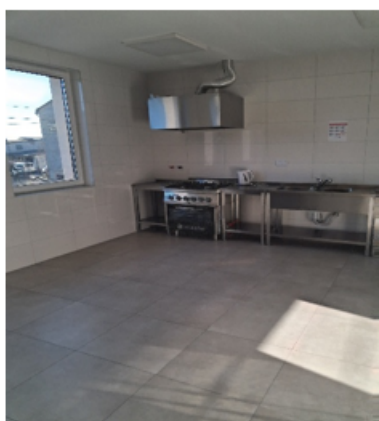
Zdjęcie Nr 7 – Kuchnia (rozdzielnia posiłków)
