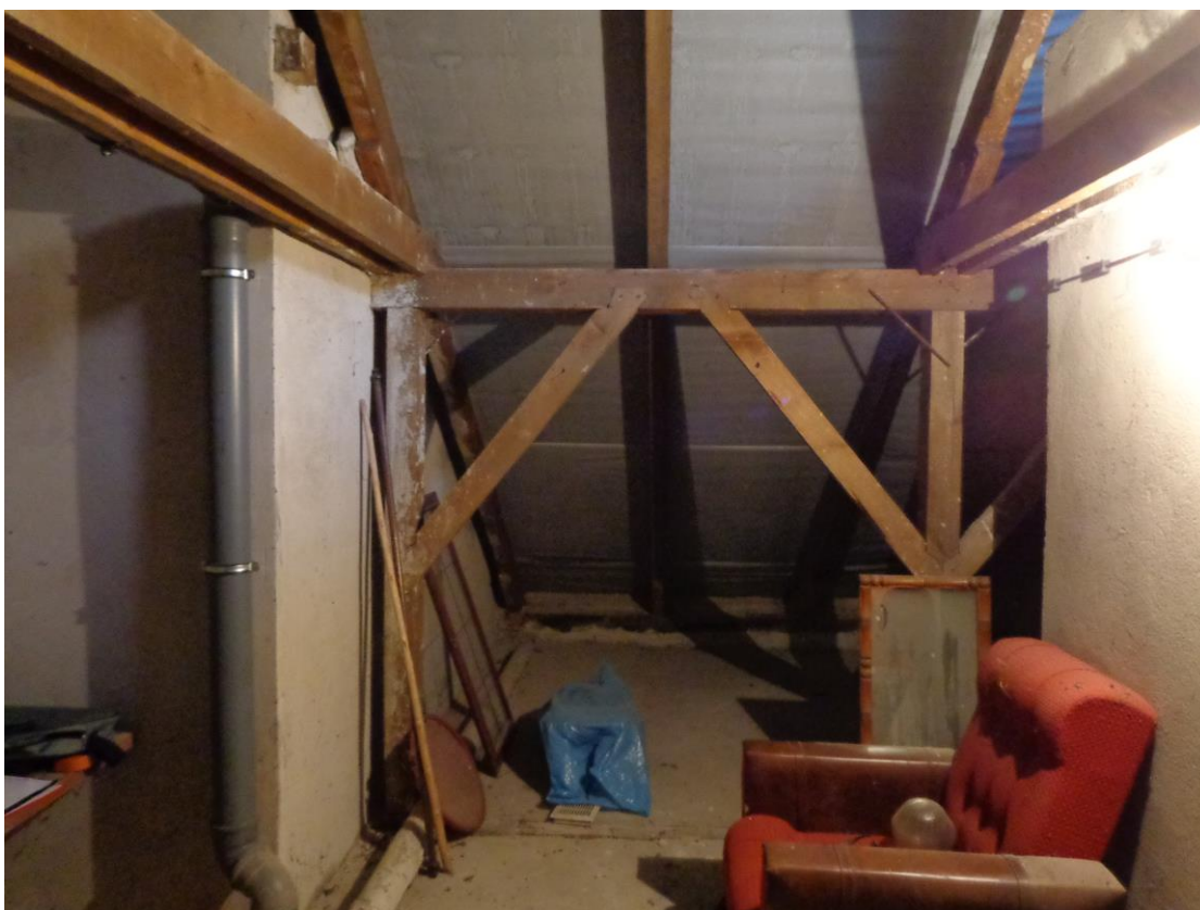
Fot.6 Dach nieocieplony na strychu.
