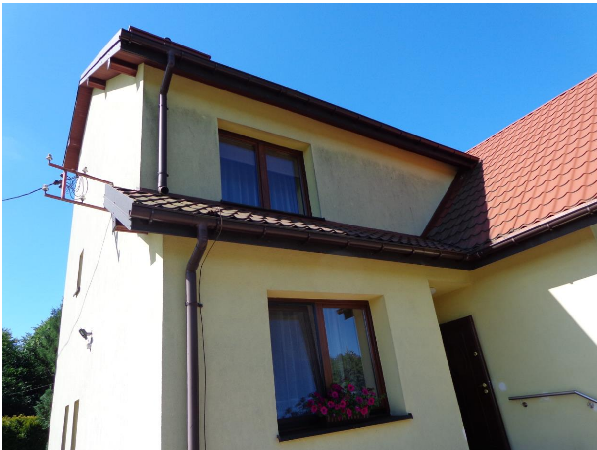
Fot.3. Przebarwienia na elewacji spowodowane czynnikami atmosferycznymi.
