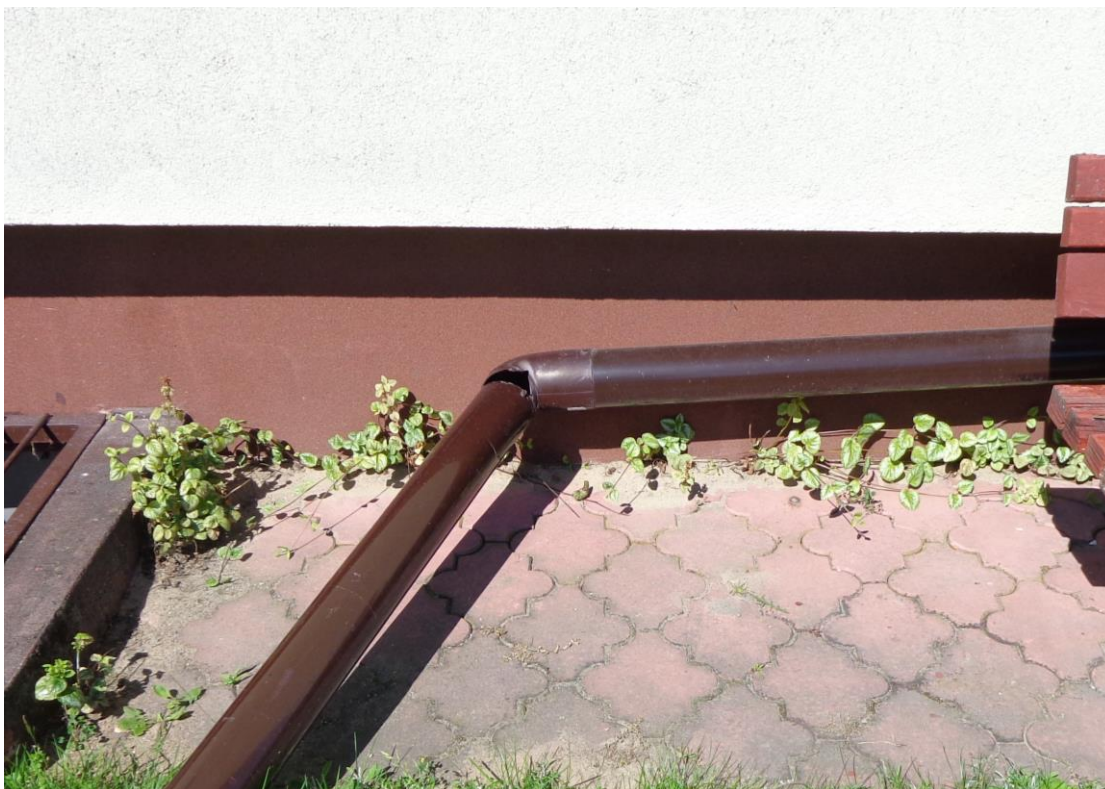
Fot.5. Widoczne uszkodzenia rury spustowej.
