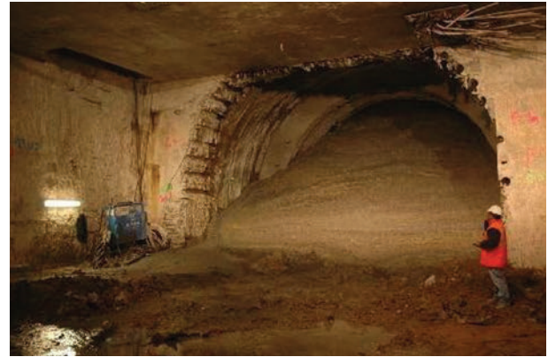
► Rys. 12. Widok rejonu czoła przodka po wystąpieniu przebiccia hydraulicznego
