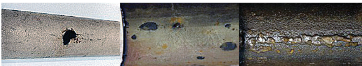
► Rys. 1. Fragmenty rur obrazujące korozję ogólną i wżerową
