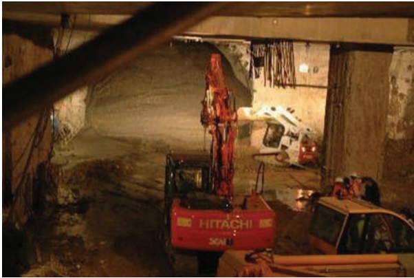
► Rys. 11. Początkowa faza wypływu gruntu po przebicju stropu wyrobiska
