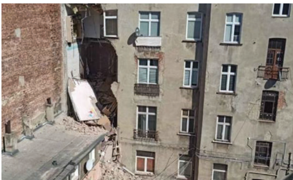
► Rys. 13. Zawalona ściana szczytowa kamienicy przy Al. 1 Maja 23 w Łodzi; widoczne uszkodzenia konstrukcji powstałe w wyniku przemieszczeń gruntu podczas przejścia tarczy TBM Katarzyna
