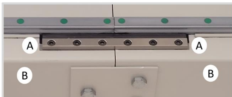
Ilustracja 6. Możliwe lokalizacje występowania pęknięć
