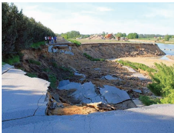
► Rys. 7. Osuwisko w ZG „Zastawie IV-2” [4]
