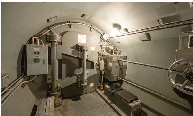
Fot. 5. Wnętrze wejściowej śluzy powietrznej do obudowy bezpieczeństwa w bloku Vogtle 3 (źródło: Georgia Power Company).
