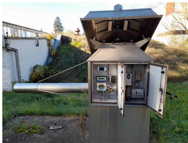
Fot. 1. Nowy model stacji ASS-500 (stacja NASS-500) (źródło: zdjęcie własne).
