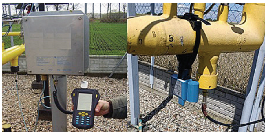
► Rys. 4. System monitorowania postępu korozji za pomocą sondy
