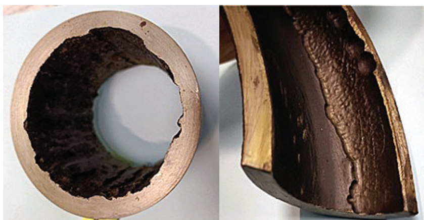
► Rys. 2. Fragment rurociągu obrazujący korozję wżerową
