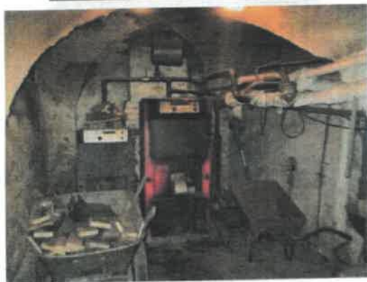
kotłownia w piwnicy
