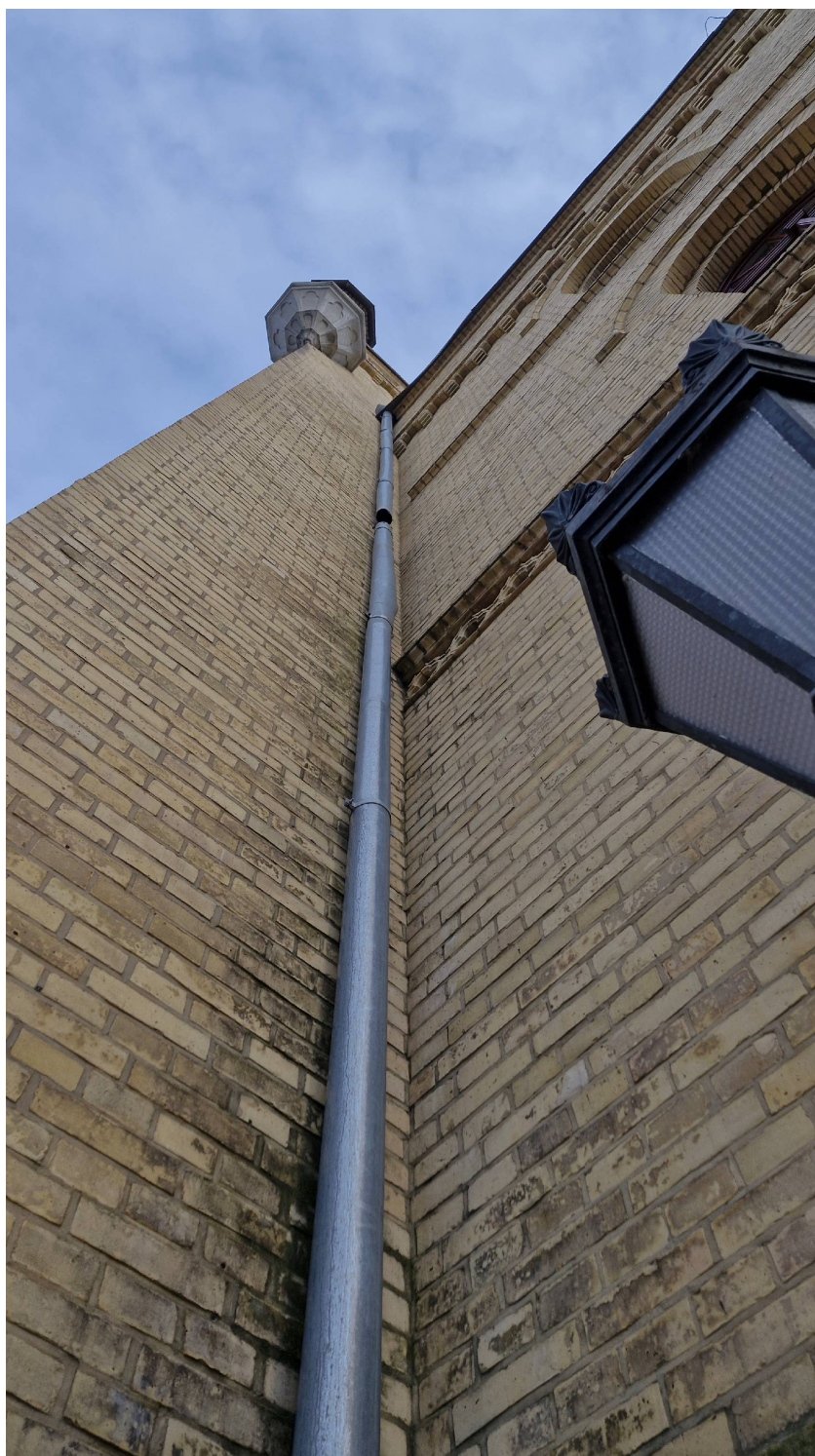
Istniejące rury spustowe – brakujący element przy wejściu głównym
