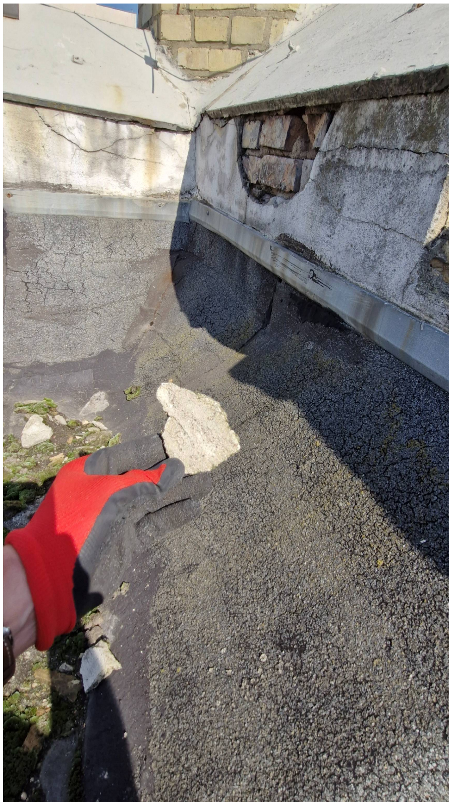
Ubytki tynku od wewnętrznej strony attyki wieży
