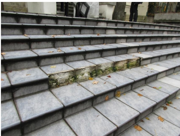
Fotografia 1. Widok uszkodzenia schodów dolnych (część wtórna).
