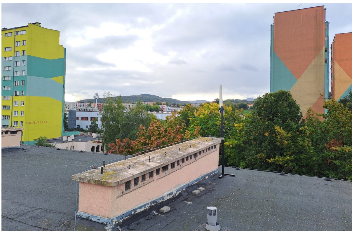
Rys. 2 Miejsce montażu SMS PEM – Publiczna Szkoła Podstawowa nr 15 – widok na SBTk
