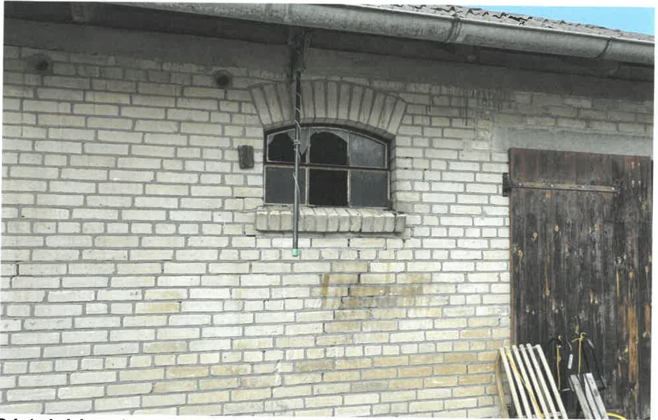
Pęknięcia ścian, zalewanie ścian, wypłukiwanie zaprawy, zużycie stolarki
