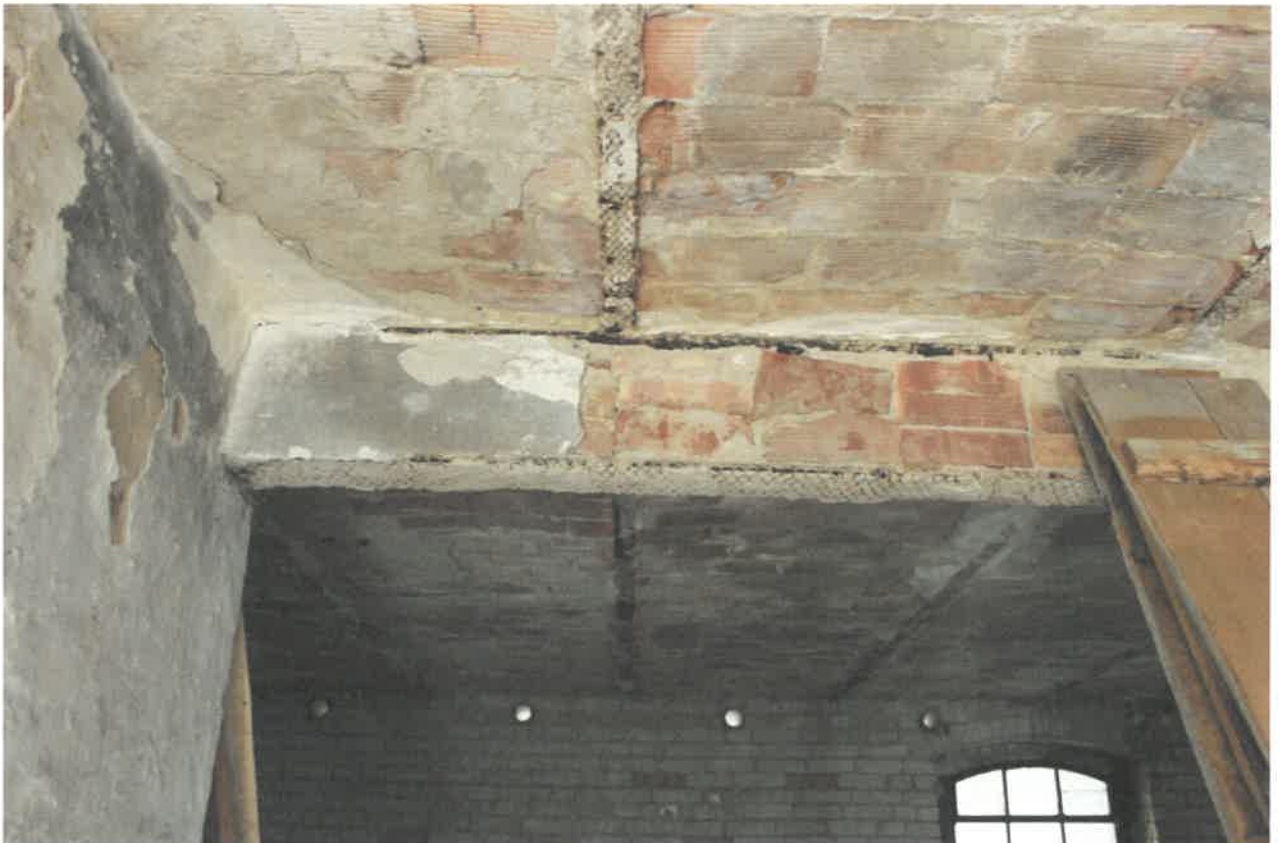
Uszkodzenia wewnątrz spowodowane nieszczelnością dachu. Odpadł tynk ze stropu. Korozja profili stalowych
