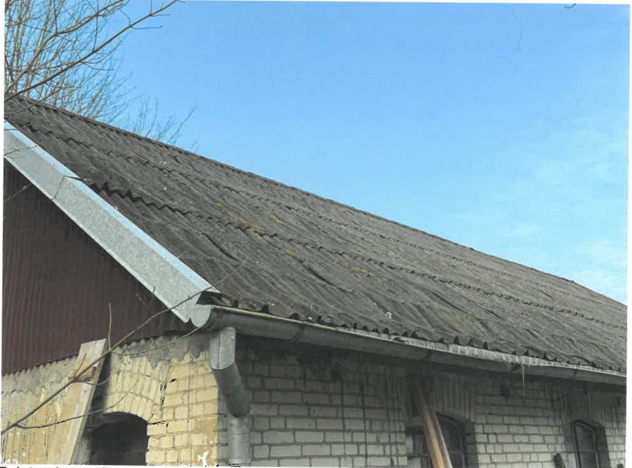
Zużyte, nieszczelne i uszkodzone pokrycie dachowe
