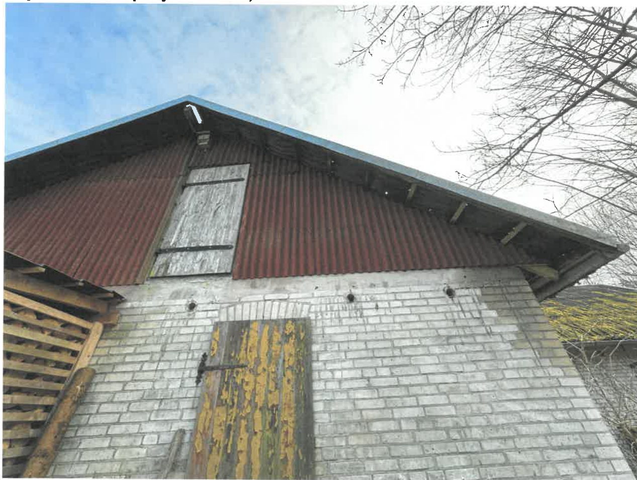
Nieszczelność dachu w kalenicy, na połaci pod okapem
