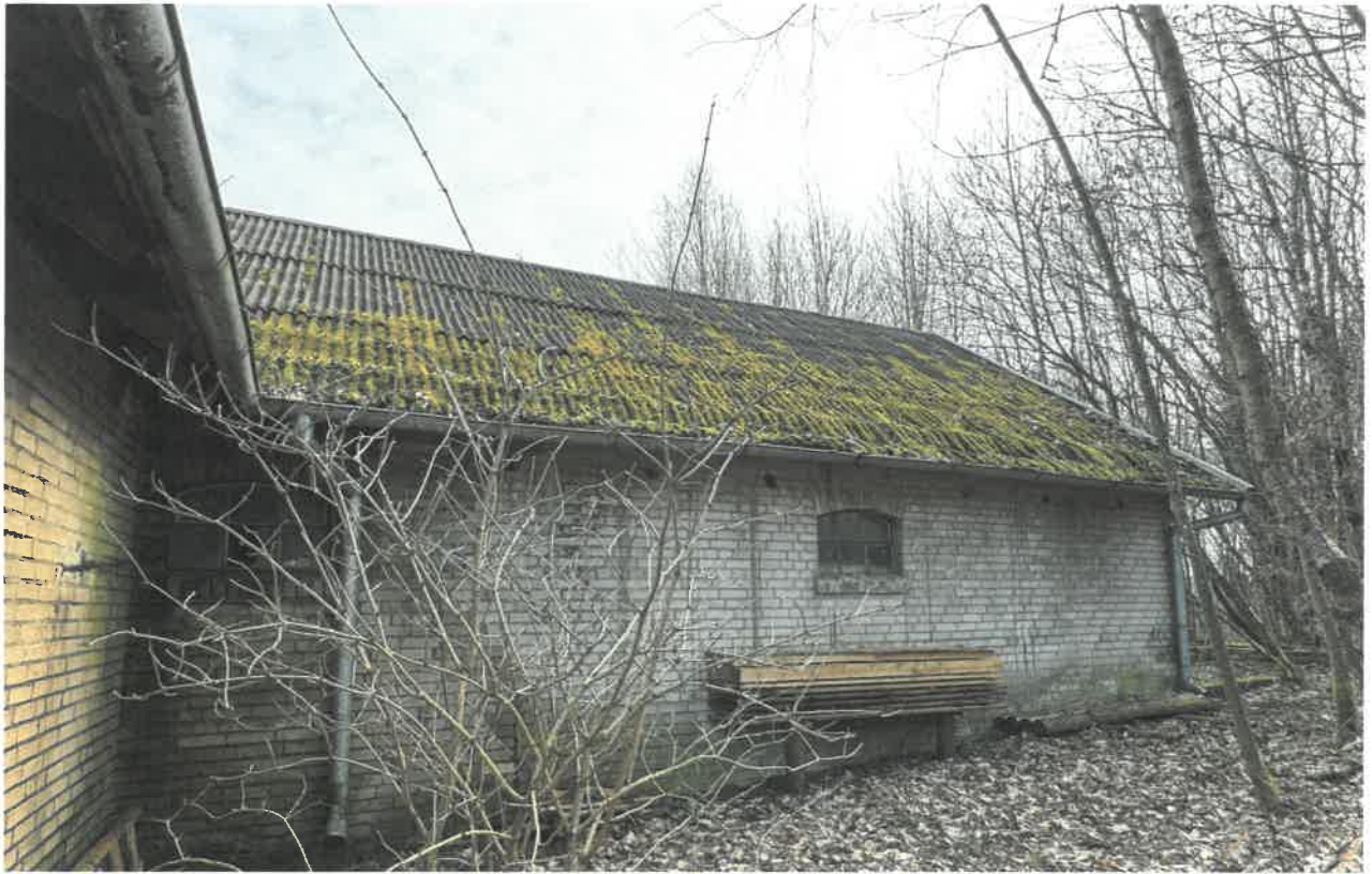
Zalewanie ścian, zużycie połaci dachu
