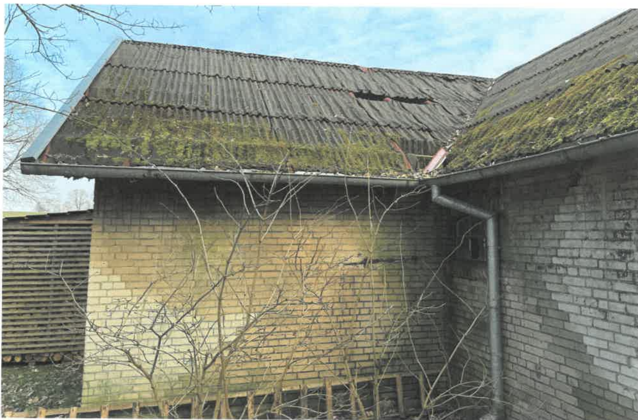
Zużyte, nieszczelne pokrycie dachowe, zalewanie ścian
