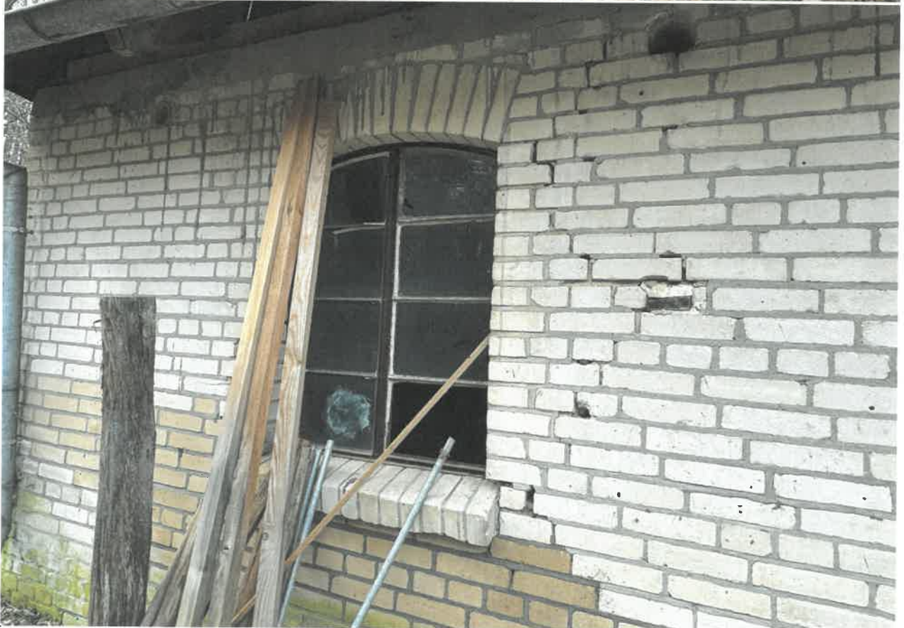
Pęknięcia ścian, zużycie stolarki
