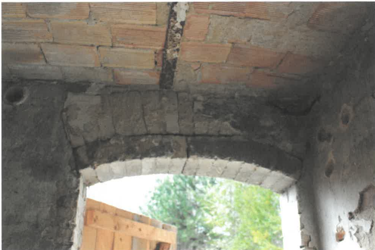
Uszkodzenia wewnątrz spowodowane nieuszczelnością dachu. Odpadł tynk ze stropu
