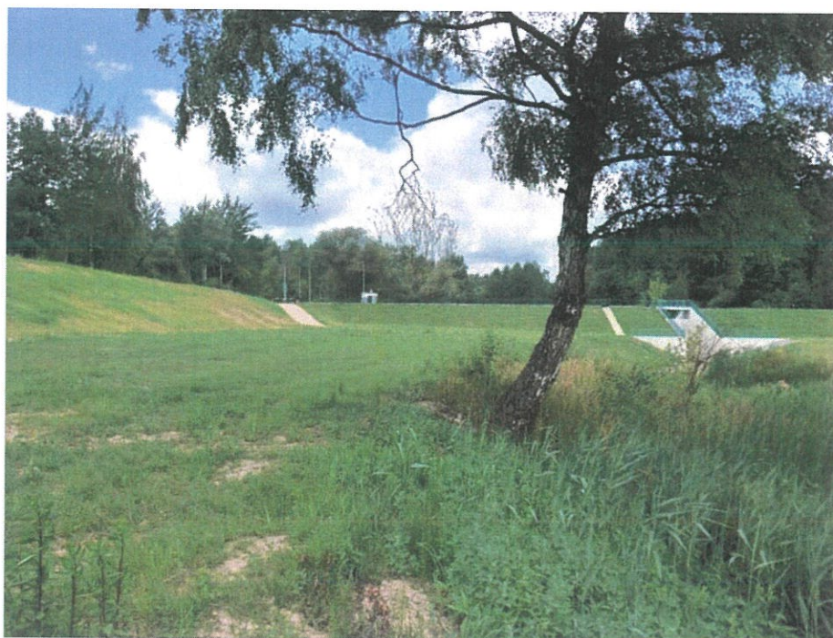
Foto. 62. Porost traw w czaszy zbiornika na południowym brzegu potoku Malinówka, stan w trzeciej dekadzie czerwca 2025 r. (widok w kierunku zachodnim).
