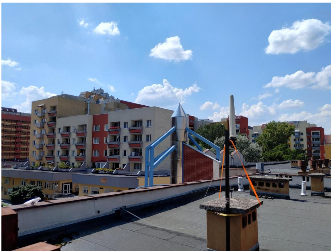
Rys. 2. Miejsce montażu SMS PEM – Szkoła Podstawowa nr 118
