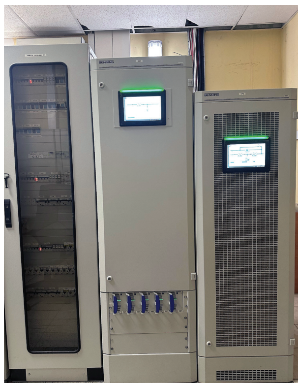
► Rys. 5. UPS z siłownią telekomunikacyjną i tablicą rozdzielczą
