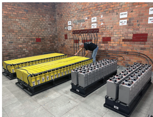
► Rys. 4. Baterie akumulatorów
