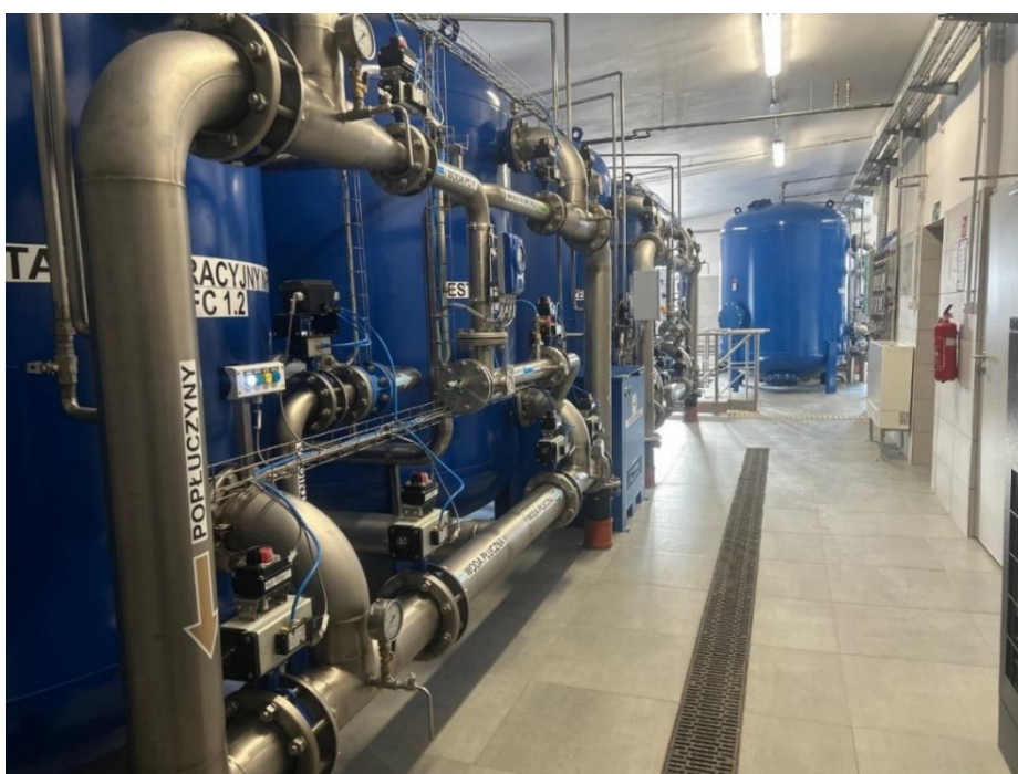
Fot. Wnętrze budynku Stacji Uzdatniania Wody w Krasnem (źródło: Zakład Usług Komunalnych w Krasnem)
