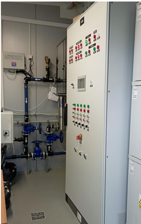
Fot. Zestaw pomp w budynku Stacji Uzdatniania Wody Rzeszów, ul. Podleśna (źródło: zasoby własne PSSE w Rzeszowie)
