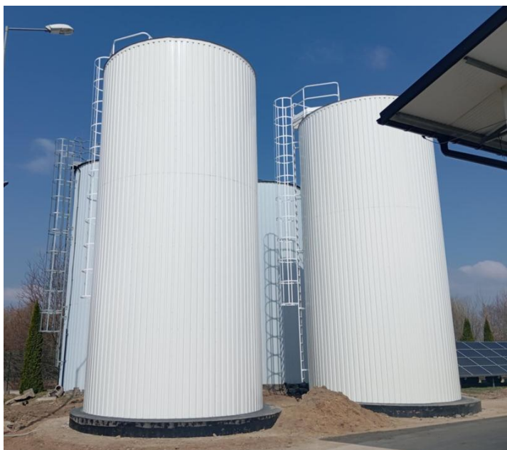
Fot. Zbiorniki wieżowe wodociągu Lubenia (źródło: Urząd Gminy Lubenia)
