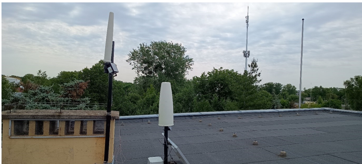
Rys. 3 Miejsce montażu SELMS PEM – Ik-PIB we Wrocławiu – lokalizacja 1
