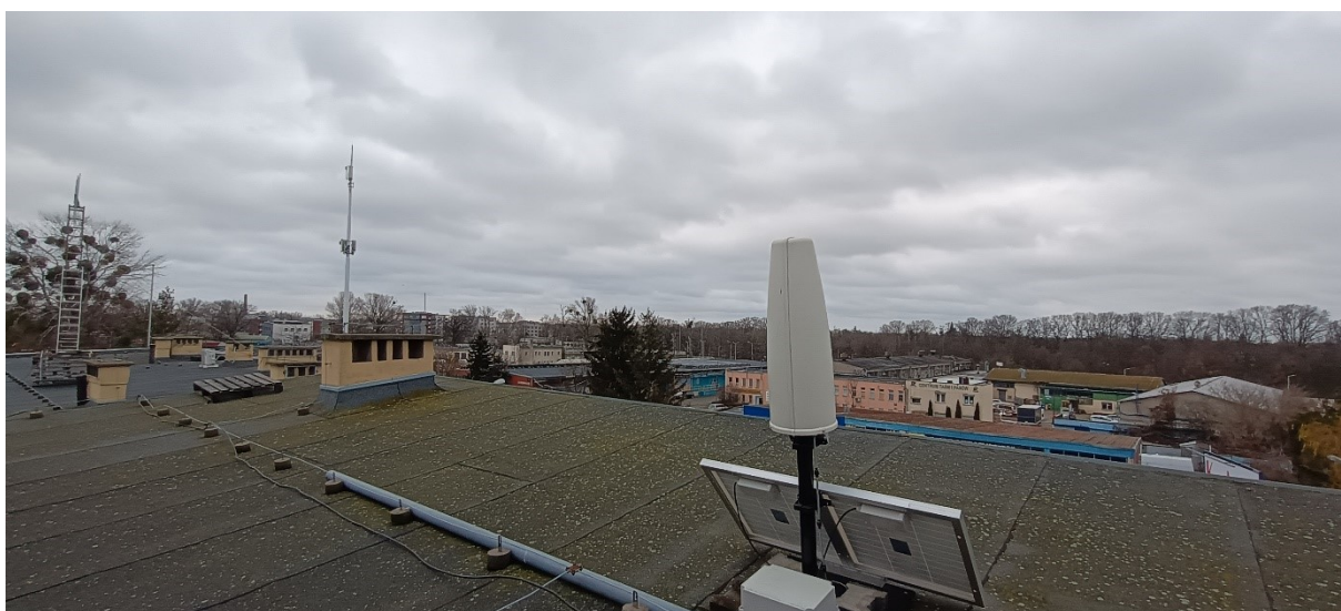
Rys. 4 Miejsce montażu SELMS PEM – Ik-PIB we Wrocławiu – lokalizacja 2
