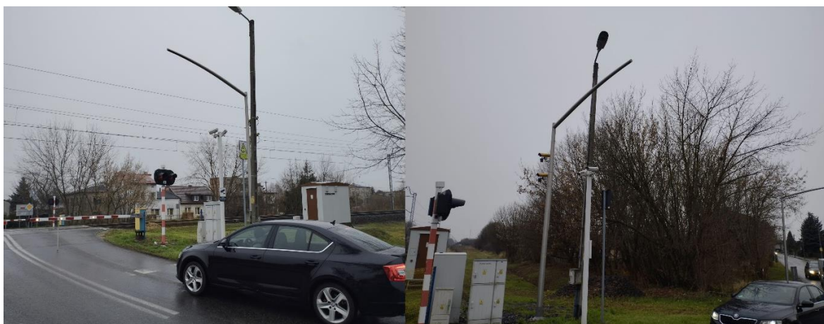
Zdj. 9-10 oznakowanie i rozmieszczenie kamer w strefie monitorowanej na DP 3952E-ul.Piłsudskiego w Radomsku.
