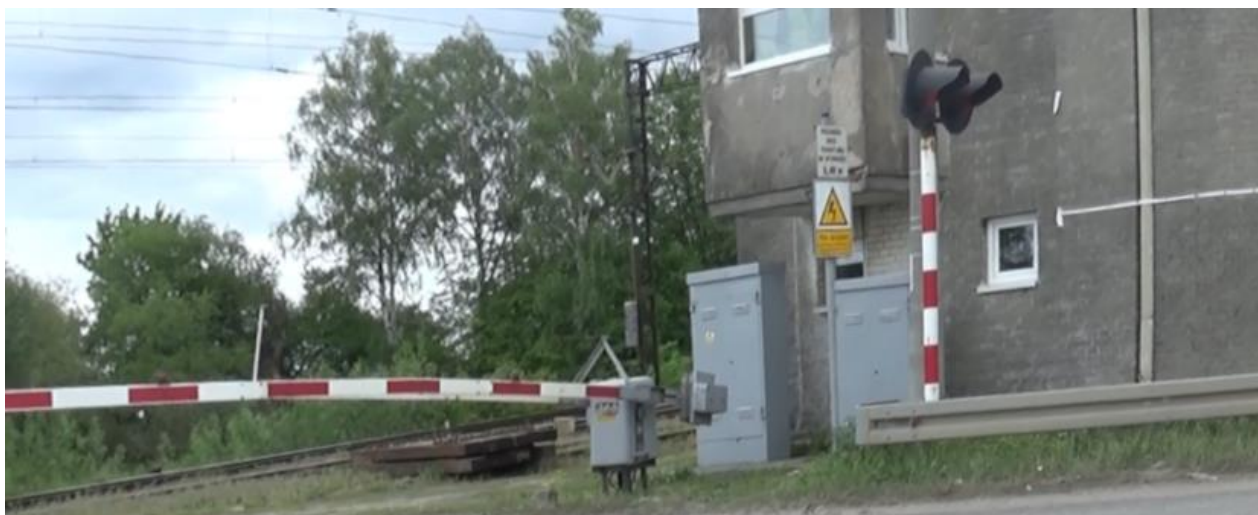
Zdjęcie 12 - Widok sygnalizatora S2 z kierunku jazdy samochodu dostawczego (źródło: KPP Aleksandrów Kujawski)
