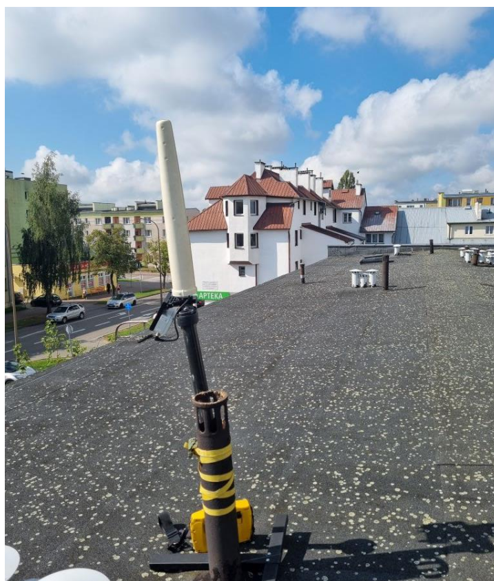
Rys. 2. Miejsce montażu SMS PEM – Przychodnia Lekarska w Suwałkach
