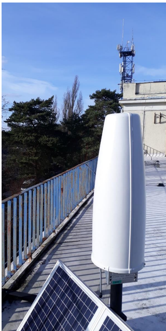
Rys. 3 Miejsce montażu SELMS PEM – IŁ-PIB w Warszawie – lokalizacja 2
