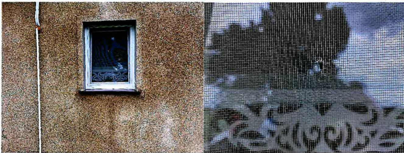
W oknie lewym dolnym w zamontowanej moskitierze widoczny otwór o nierównomiernych krawędziach, znajdujący się na wysokości 1,65m od podłoża – ...144122, ...144148
