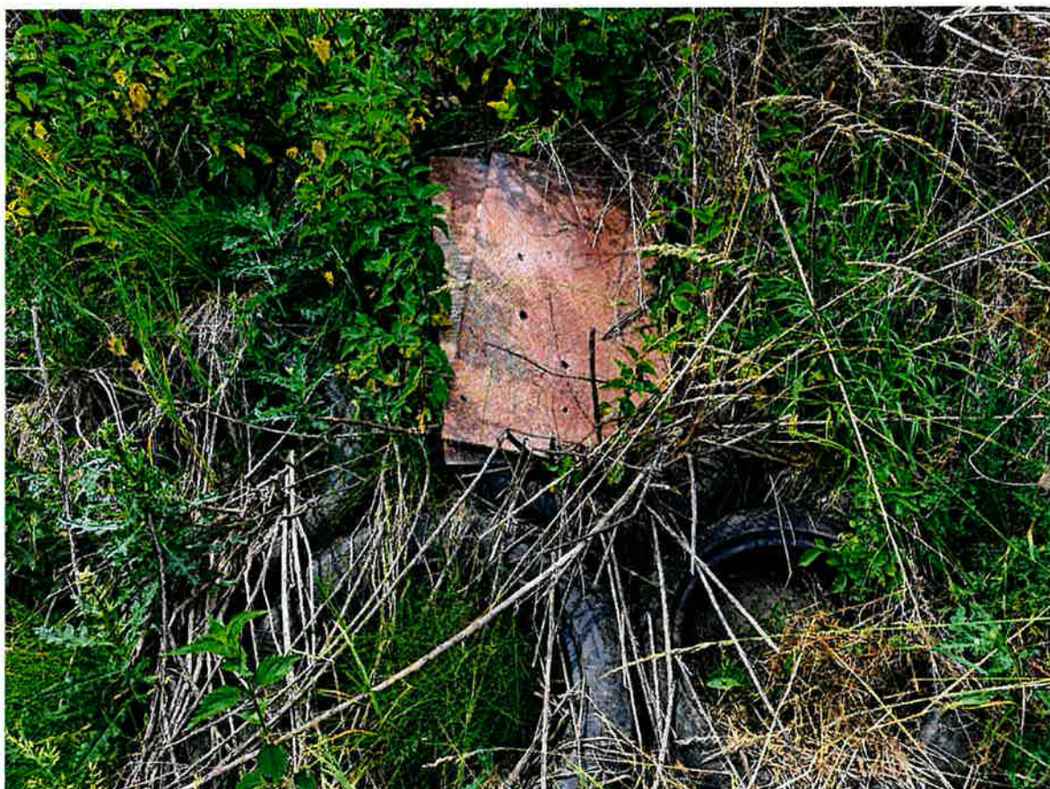
Elementy metalowe (blachy) na prawym nasypie patrząc w stronę kulochwyty – ...124829
