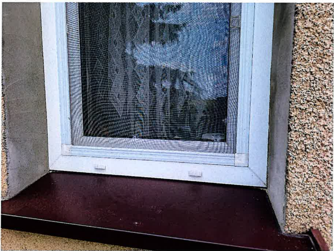
w oknie pierwszym zamontowana moskitiera w której widoczne są dwa otwory o nieregularnych kształtach na wysokości 1,38m, ...144905
