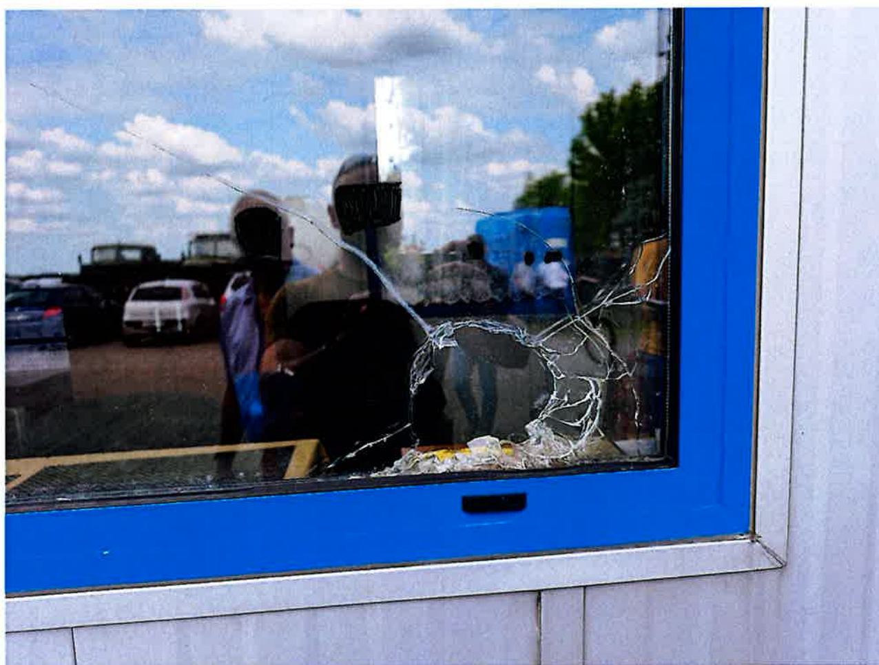
Szyba portierni podwójna, w przedniej tafli patrząc do wnętrza budynku (stojąc tyłem do strzelnicy) widoczny otwór o nieregularnych krawędziach - ...134606
