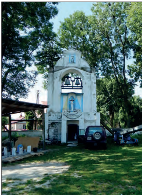
61. Wojsławice, dzwonnica kościelna, stan przed remontem, fot. S. Rudnik, 2014.
