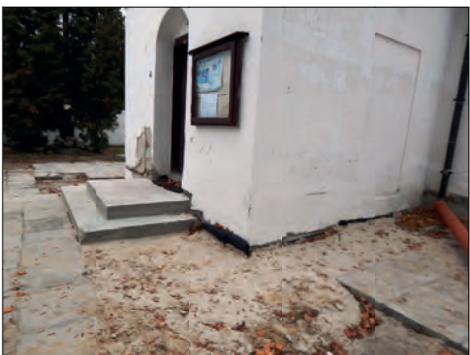
54. Klesztów, kościół rzymskokatolicki, stan w trakcie naprawy ścian fundamentowych, fot. M. Pędzińska, 2014.
