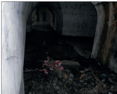
3. Koroszczyn, fort „O”, otwór wybity w podłodze w części centralnej szyi, fot. P. Zieniuk, 2015.
