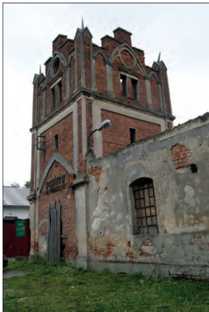
1. Dominów, Wieża - brama wjazdowa w zespole dworsko – parkowym, stan przed remontem, fot. J. Matys, 2011.
