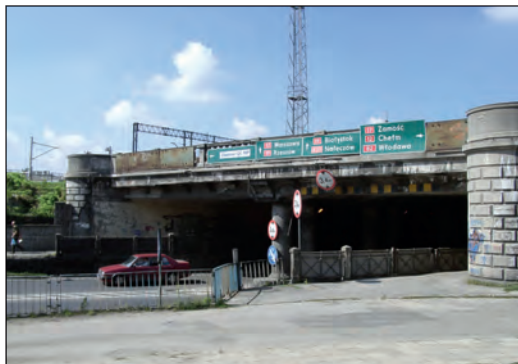
1. Wiadukt kolejowy przy ul. Kunickiego w Lublinie, przed remontem, 2004.
